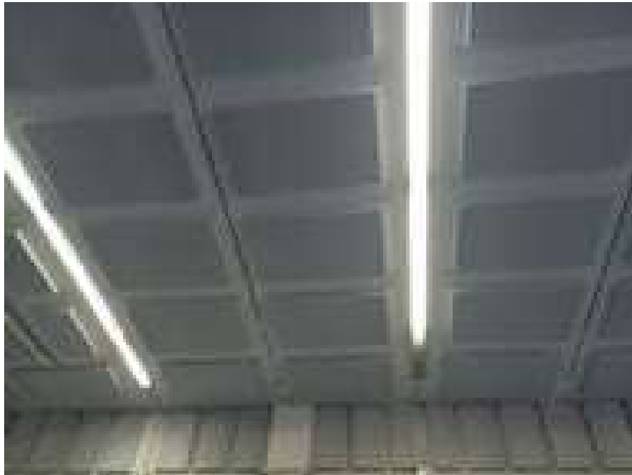
Imatge sostre condicionat acústicament gimnàs escola Saavedra
