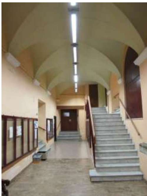
Estat actual que presenta la volta de l'antiga galeria de l'antic convent.
