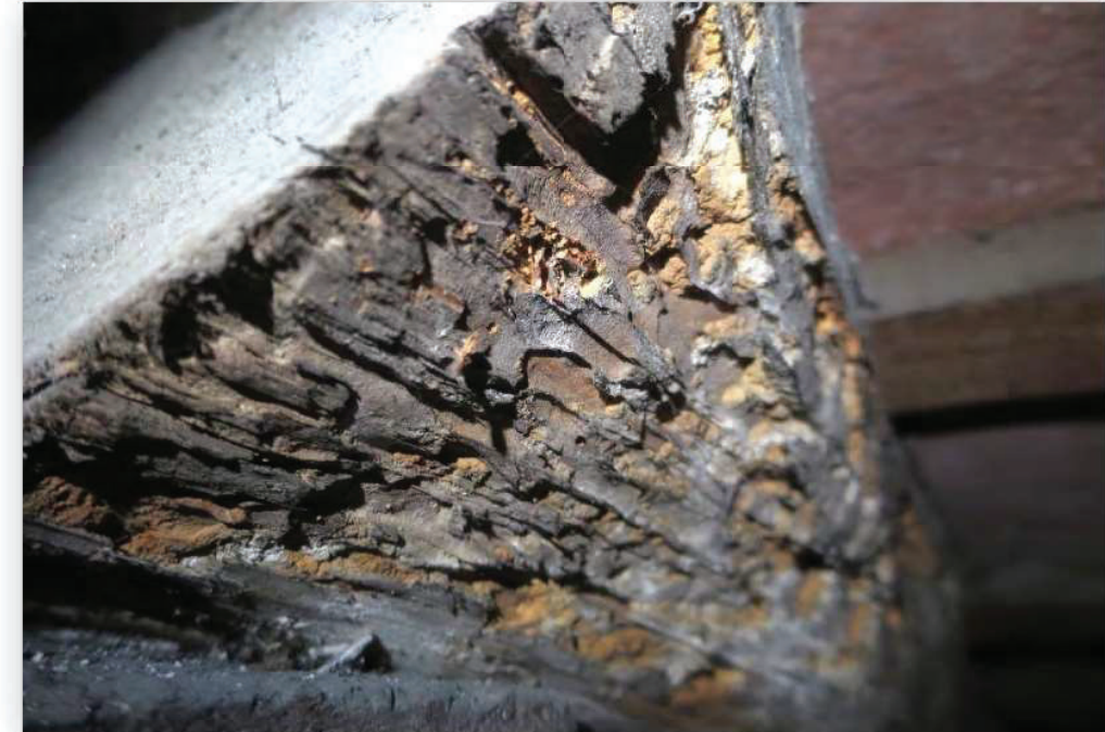
Sostre de la planta 1 (P1). Element P1B9. Imatge 458 Degradació superficial causada per corcs de gran grossària Serradures de l'interior de les galeries
