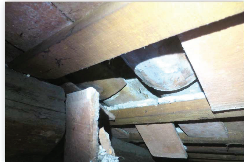
Sostre de la planta 1 (P1). Element P1B9. Imatge 381 Tauler en mal estat
