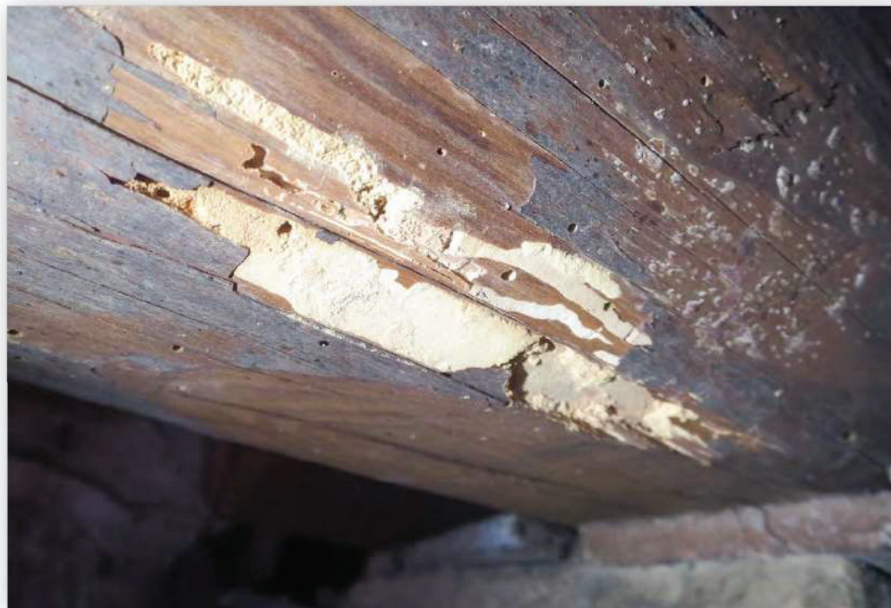
Sostre de la planta 1 (P1). Element P1C1. Imatge 378 Degradació superficial causada per corcs de gran grossària Serradures de l'interior de les galeries
