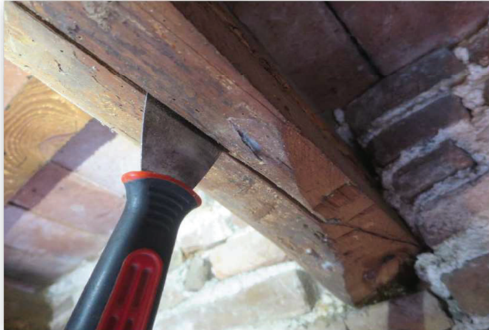
Sostre de la planta 1 (P1). Element P1C4. Imatge 377 Clivelles significatives en el pla inclinat
