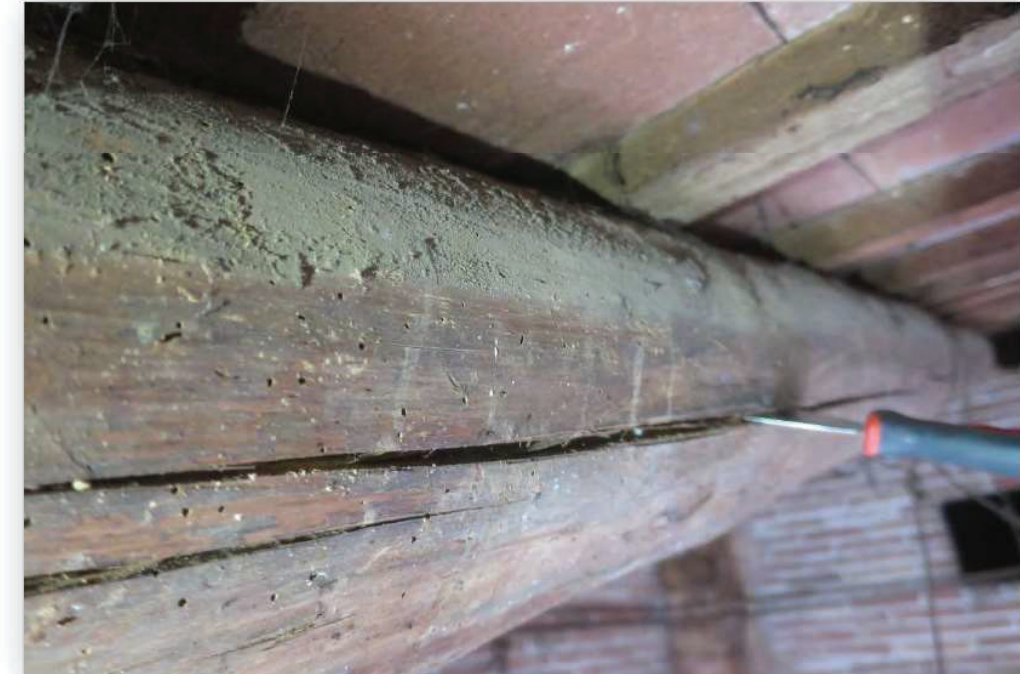
Sostre de la planta 1 (P1). Element P1C2. Imatge 376 Clivelles significatives en el pla inclinat
