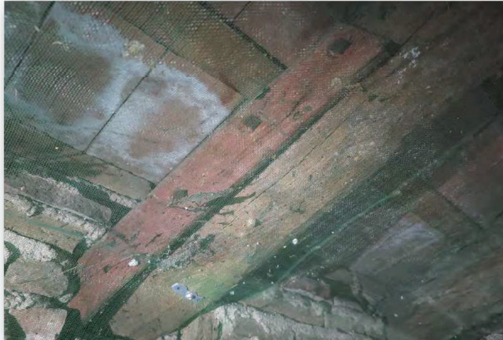
Sostre de la planta 1 (P1). Element P1A9. Imatge 374 Degradació causada per fongs de podriment Element reforçat en l'extrem nord-oest, l= 40 cm
