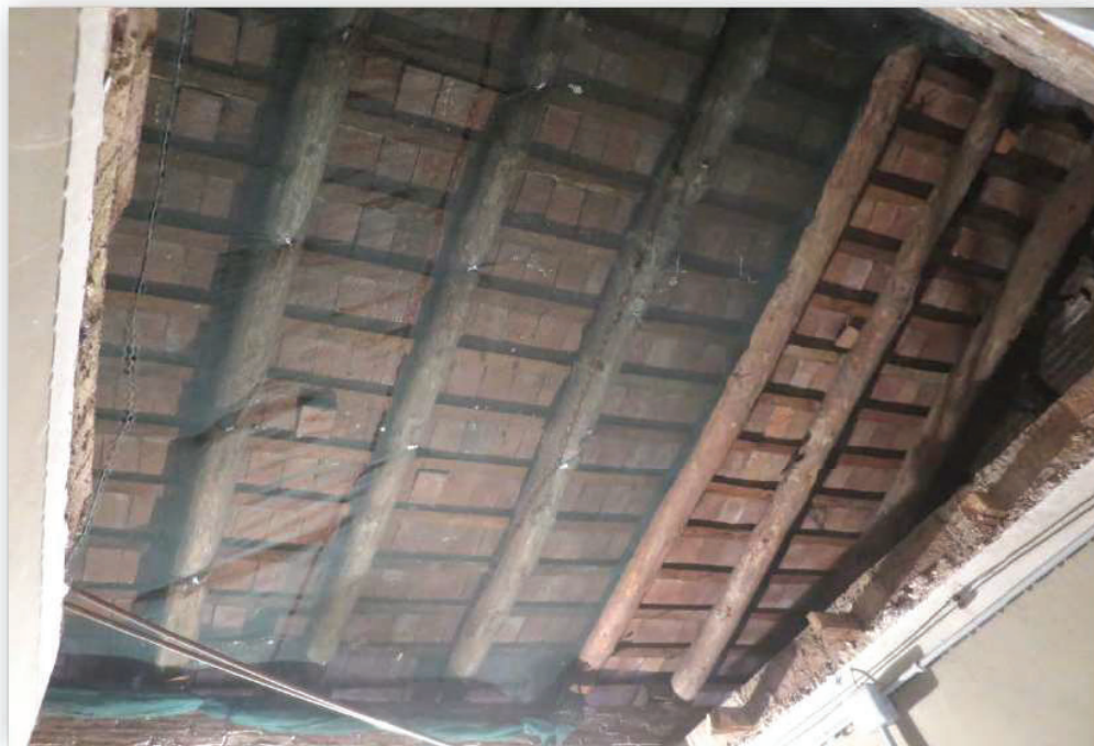
Sostre de la planta 1 (P1). Elements P1B1- P1B10. Imatge 356 Imatge dels elements Tauler en mal estat amb xarxa de protecció
