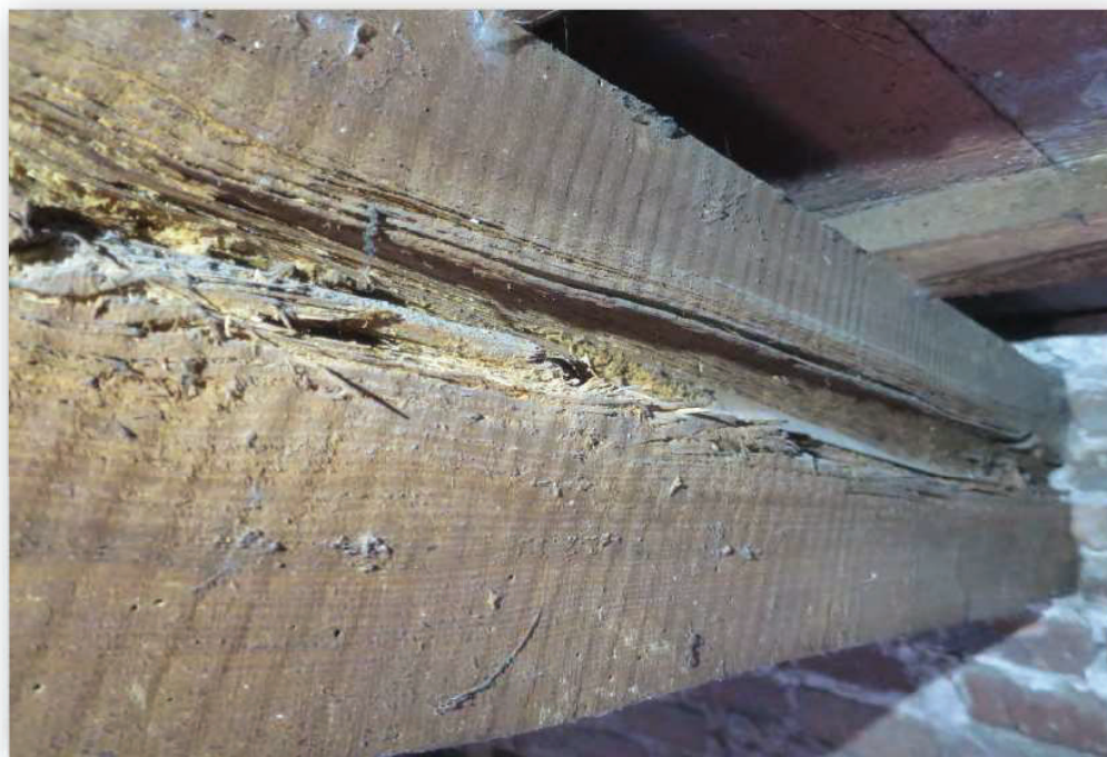
Sostre de la planta 1 (P1). Element P1C5. Imatge 388 Fenedura central provocada per la degradació del duramen
