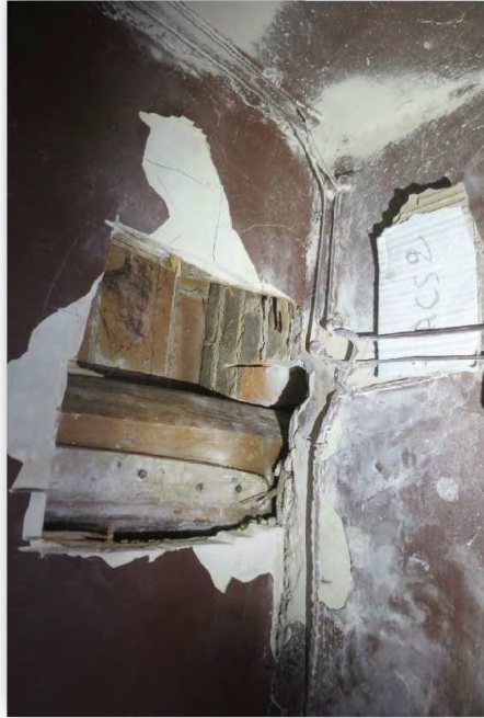
Sostre de la planta baixa (PB). Cala ACS2. Element PBC5. Imatge 365 Vista de la cala
