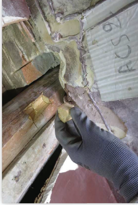
Sostre de la planta baixa (PB). Cala ACS2. Element PBC5. Imatge 462 Extracció d'una mostra de fusta
