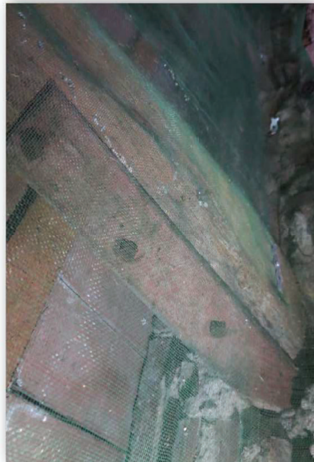
Sostre de la planta 1 (P1). Element P1A3. Imatge 372 Degradació causada per fongs de podritment Element reforçat en l'extrem nord-oest, l= 40 cm
