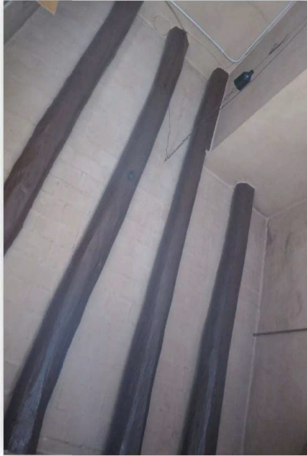
Sostre de la planta baixa (PB). Elements PBC1 - PBC4. Imatge 366 Imatge dels elements
