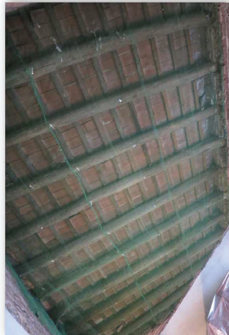
Sostre de la planta 1 (P1). Elements P1A1 - P1A10. Imatge 355 Imatge dels elements Tauler en mal estat amb xarxa de protecció
