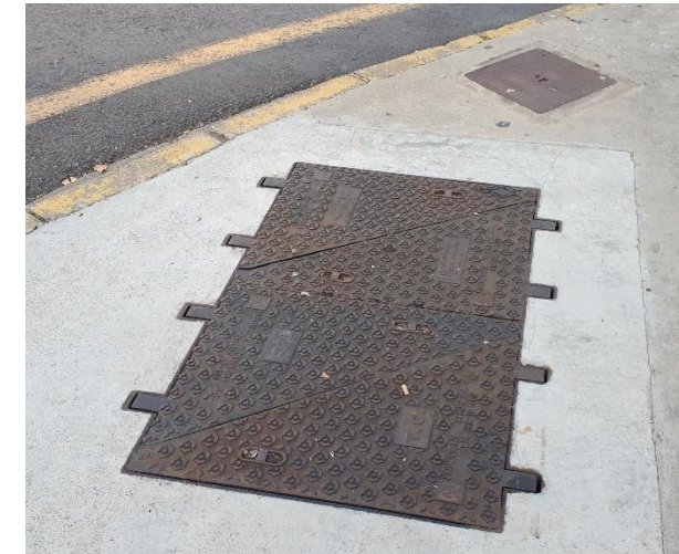
Figura 92. Registres canalització CTTI al Passeig Mossèn Jacint Verdaguer – ramal accés estació d'autobusos.
