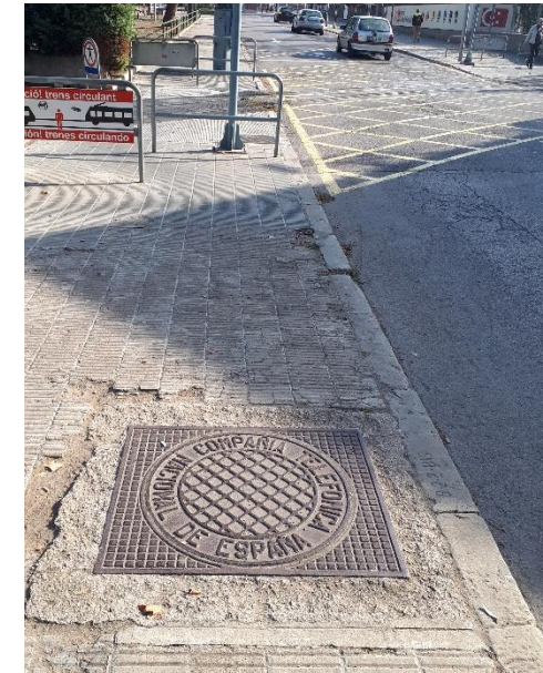
Figura 88. Registre cambra de canalització de Telefónica al pas a nivell Av. de Montserrat.
