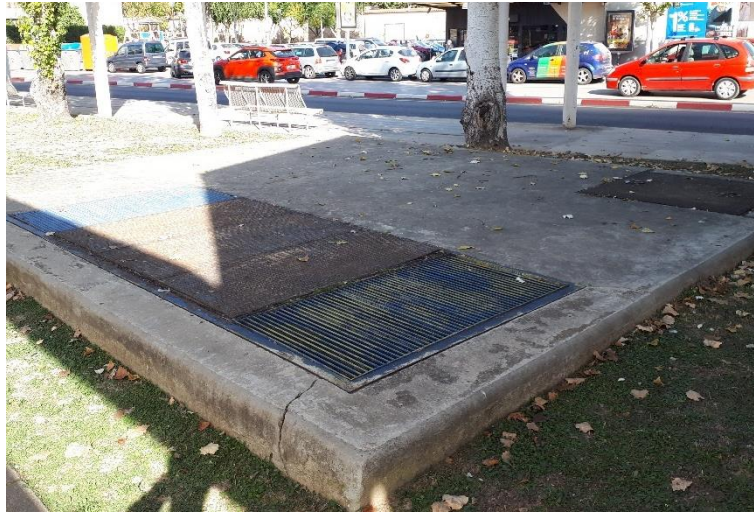
Figura 87. Centre Transformació soterrat al Passeig Mossen Jacint Verdaguer.
