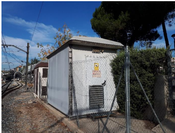
Figura 90. Sala CTTI afectada.
