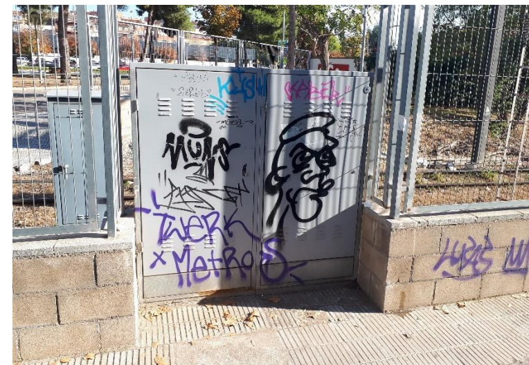
Figura 86. Armari elèctric pas a nivell Av. de Montserrat – C/ del Carrilet
