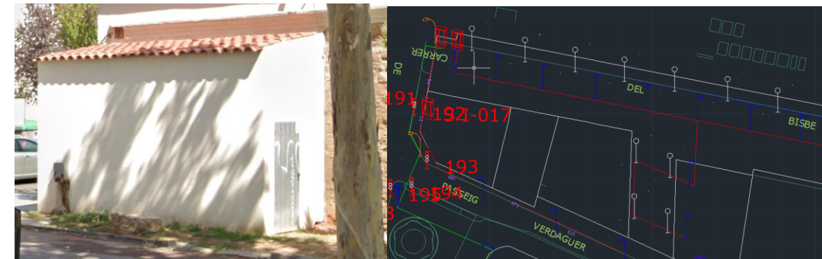
Figura 52. Zona d'ubicació dels armaris d'enllumenat existents al carrer del Bisbe. Esquerra imatge fotogràfica. Dreta plànol proporcionat per l'Ajuntament.
