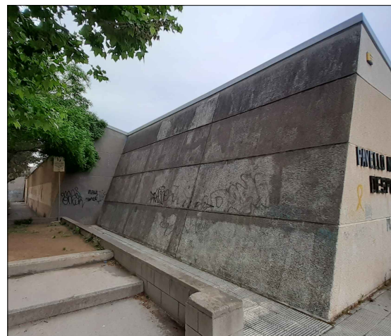
Mur inclinat enderroc parcial
