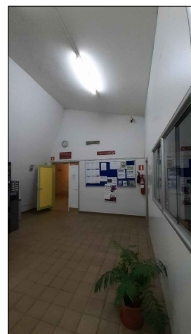
Mur inclinat enderroc parcial
