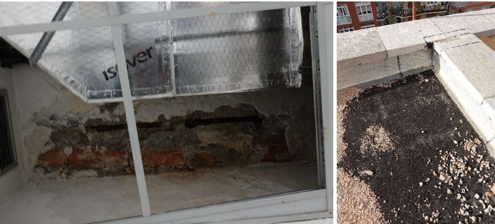
Detalls de la humitat de planta coberta que afecta el forjat i rovella l'armadura. Tela asfàltica sense protecció.
