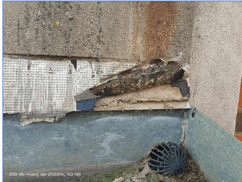
Detall estat de canalons de recollida d'aigua
