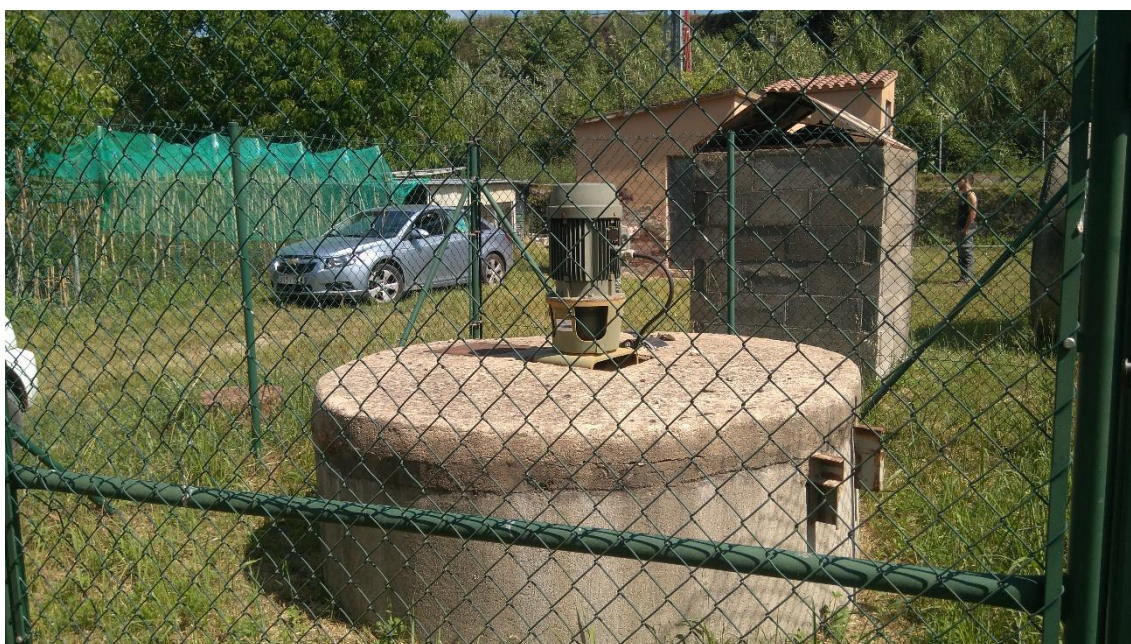
Figura 1.- Fotografia del pou 3. S'observa l'equip existent a retirar avariats.
