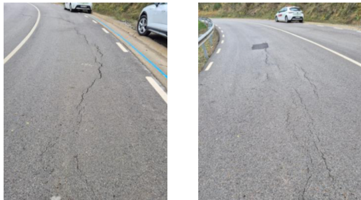
Esquerda en forma de mitja lluna i esquerdes amb enfonsament de calçada.
