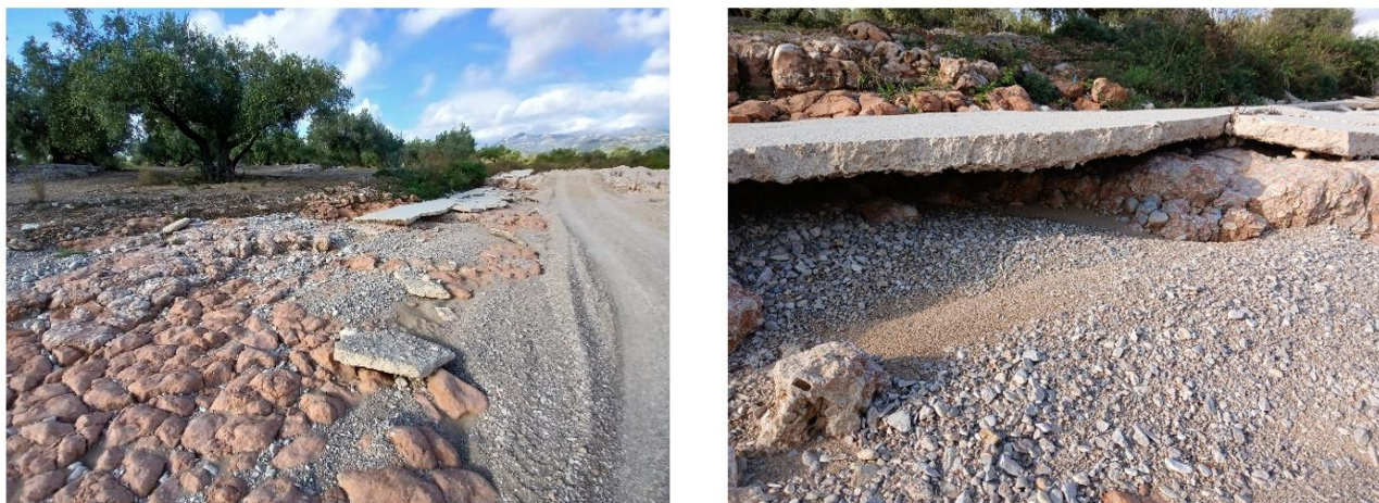
Figura 5. Tram d'escullera i plataforma de formigó trencada al camí del barranc del Cocó. Font pròpia
