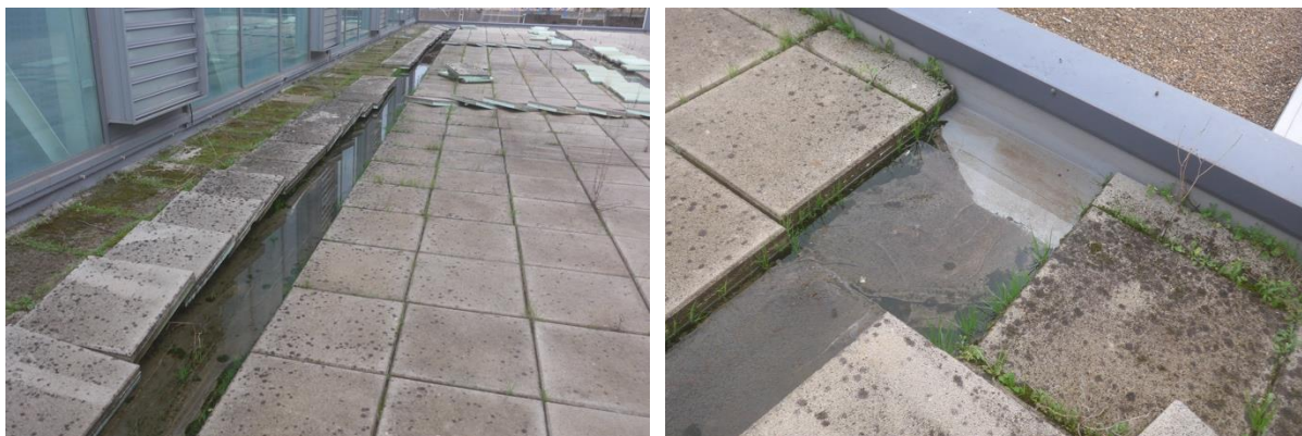
Figura D-3 Fotografies d'acumulació d'aigua i vegetació a la coberta
