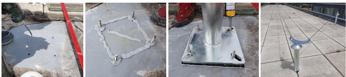
Figura A-16 Instal·lació de línia de vida
