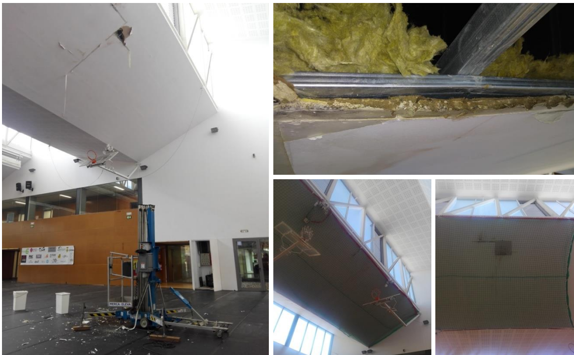
Figura A-13 Caiguda de plaques, secció del fals sostre i xarxa de protecció
