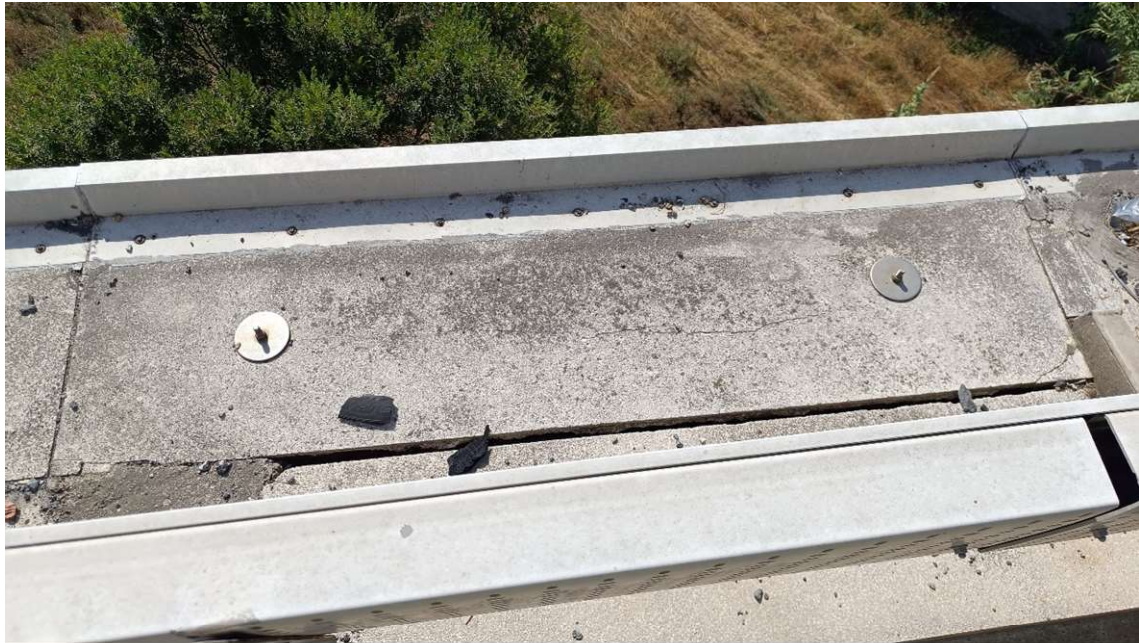
Imatges 11 a 17. Impostes degradades
