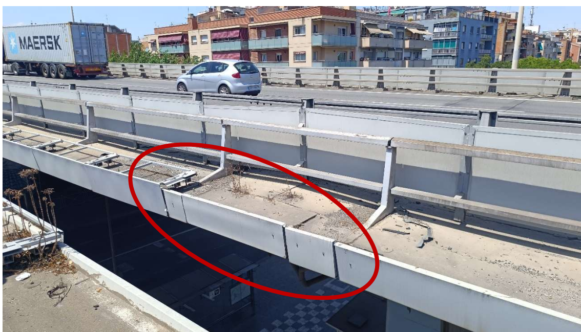
Imatges 05 a 10. Impostes degradades
