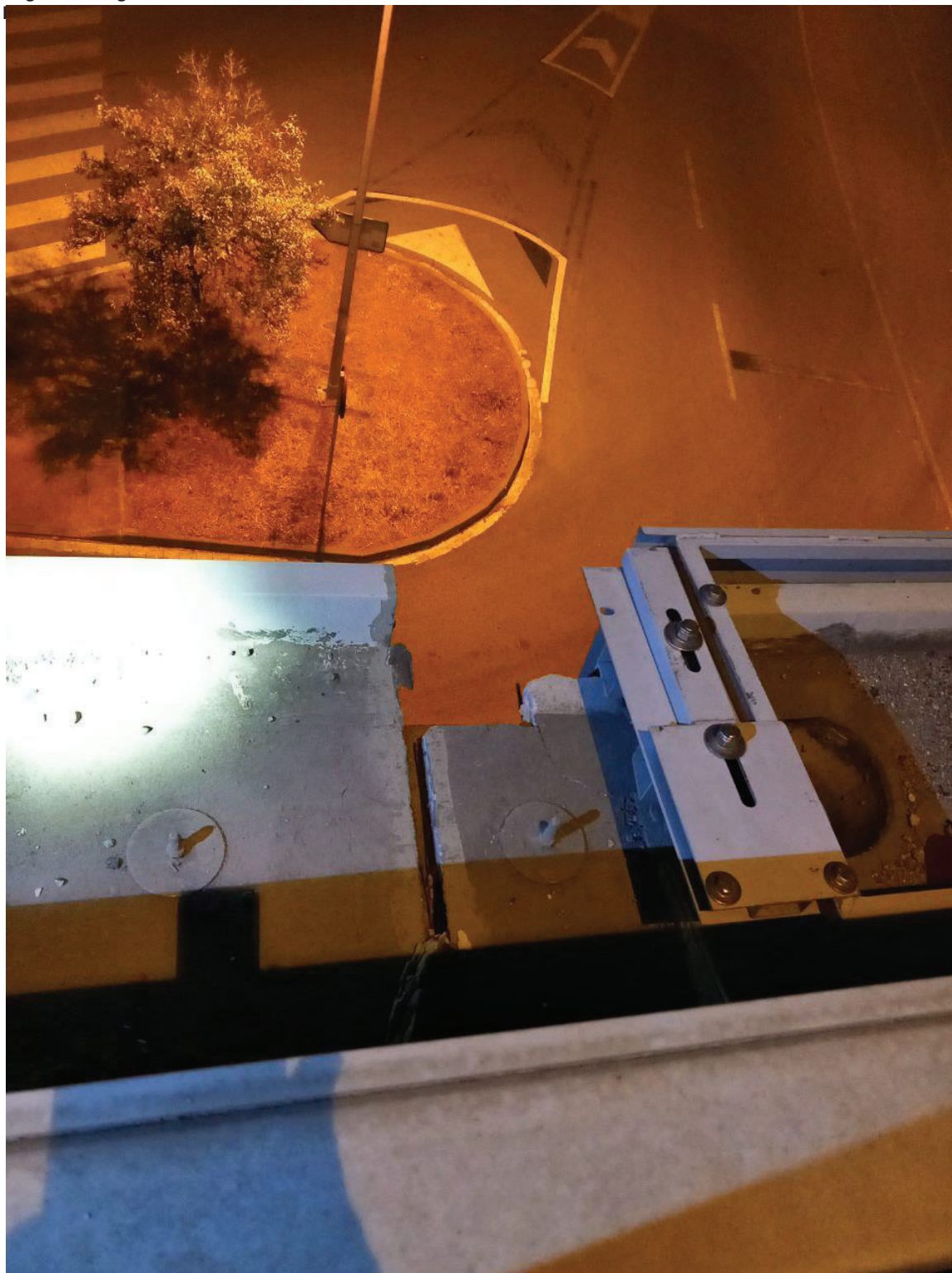
Imatge 4. Constatació de desprendiments previs al del dia 12/7/2025.
