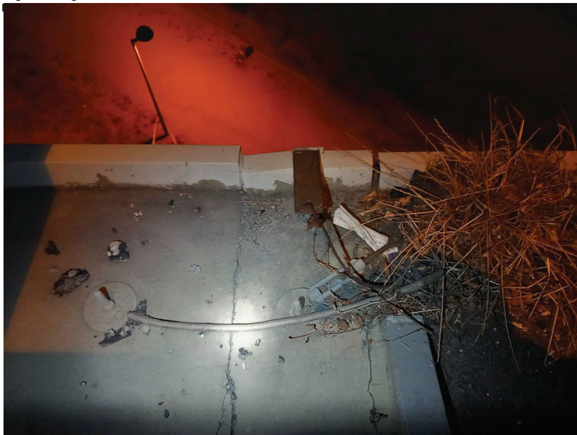
Imatge 6. Ancoratges per solventar la patologia en mal estat.
