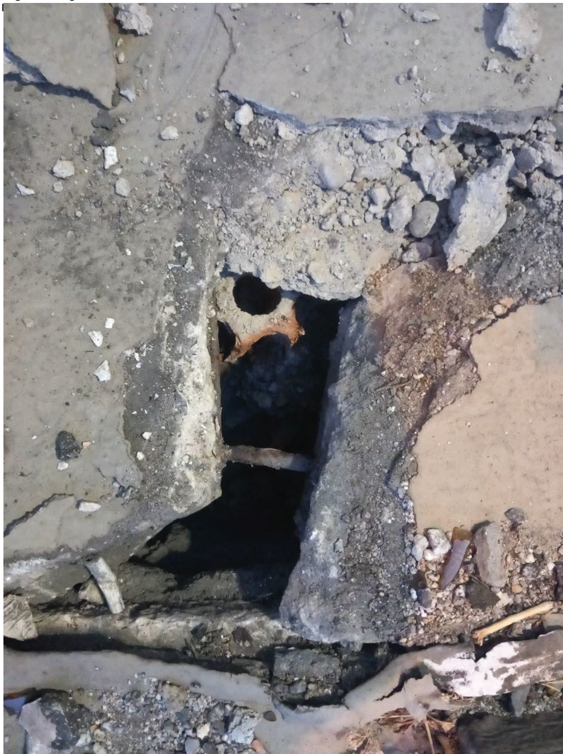
Imatge 3. Trencament superficial del formigó i degradació de les armadures
