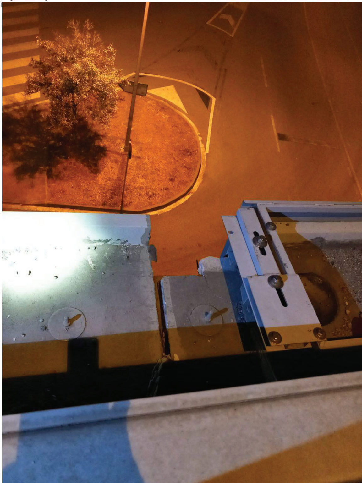
Imatge 4. Constatació de despreniments previs al del dia 12/7/2025.
