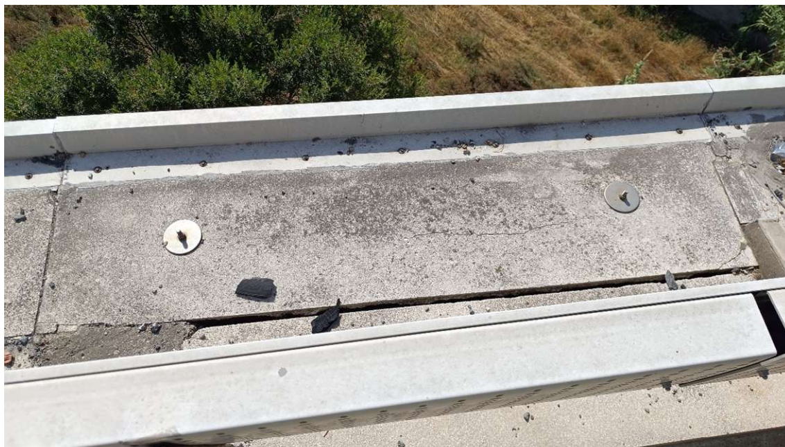
Imatges 11 a 17. Impostes degradades
