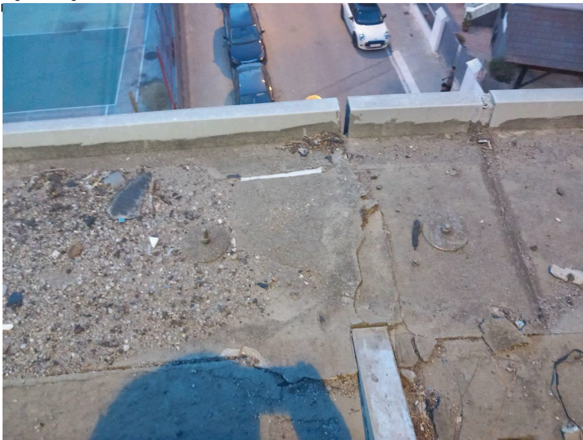
Imatge 2. Indicis de risc a 20 metres de la zona de desprendiment
