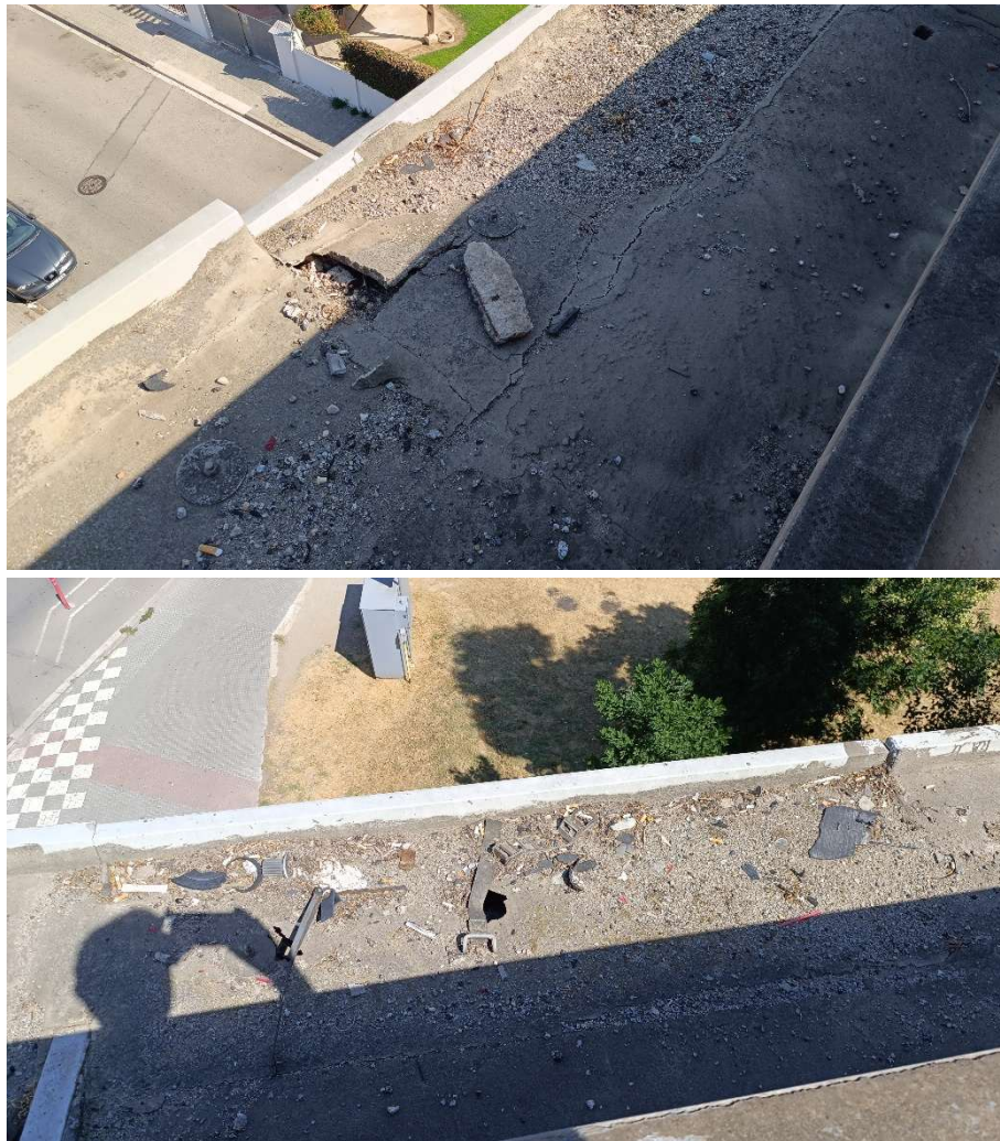
Imatges 03 i 04. Impostes degradades que es van fer caure durant la inspecció
