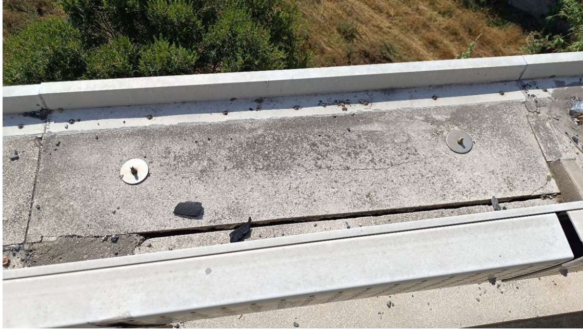
Imatges 11 a 17. Impostes degradades
