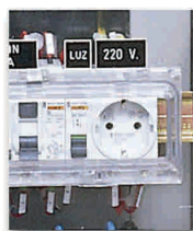
Toma de corriente
