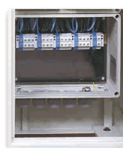
Espacio para conexiones
