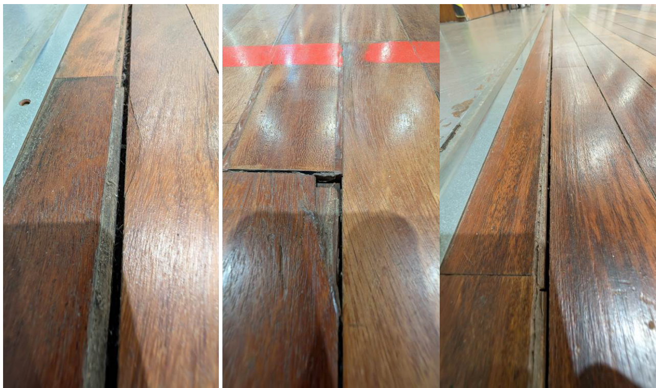
Desperfectes a les juntes perimetrals i peces de tarima malmeses
