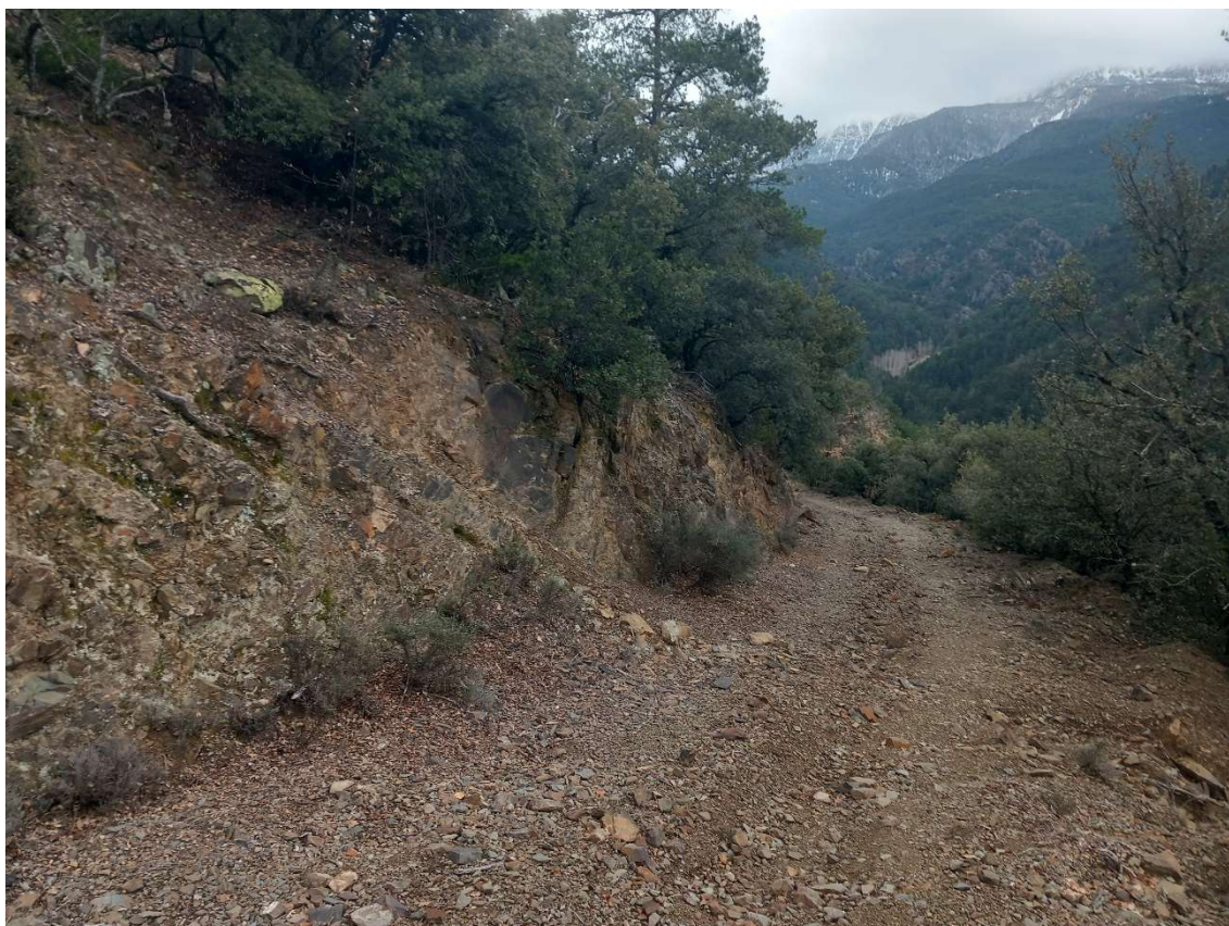
Imatge 16. Estat de la pista a Toscarre i Socarrada
