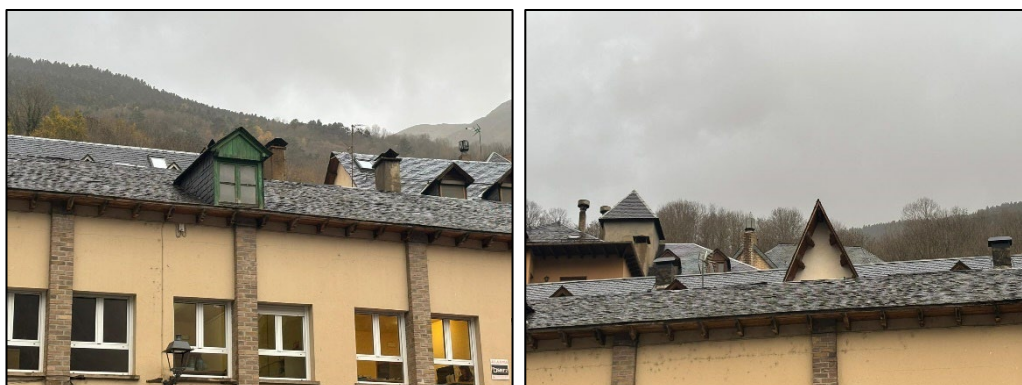
Vessants de coberta a reparar i mantenir.
