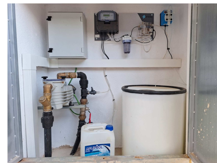
Equip de cloració automàtic
