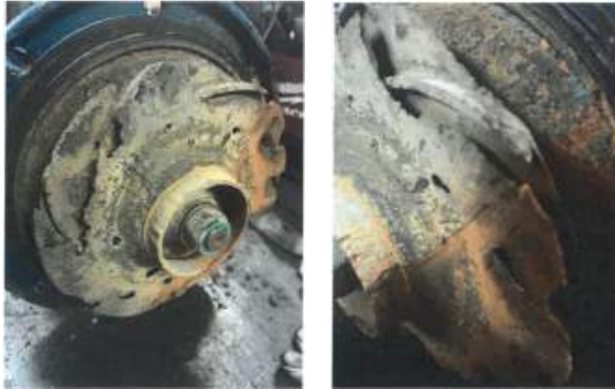
Imatge 1. Estat de la turbina de la bomba que va deixar de funcionar
