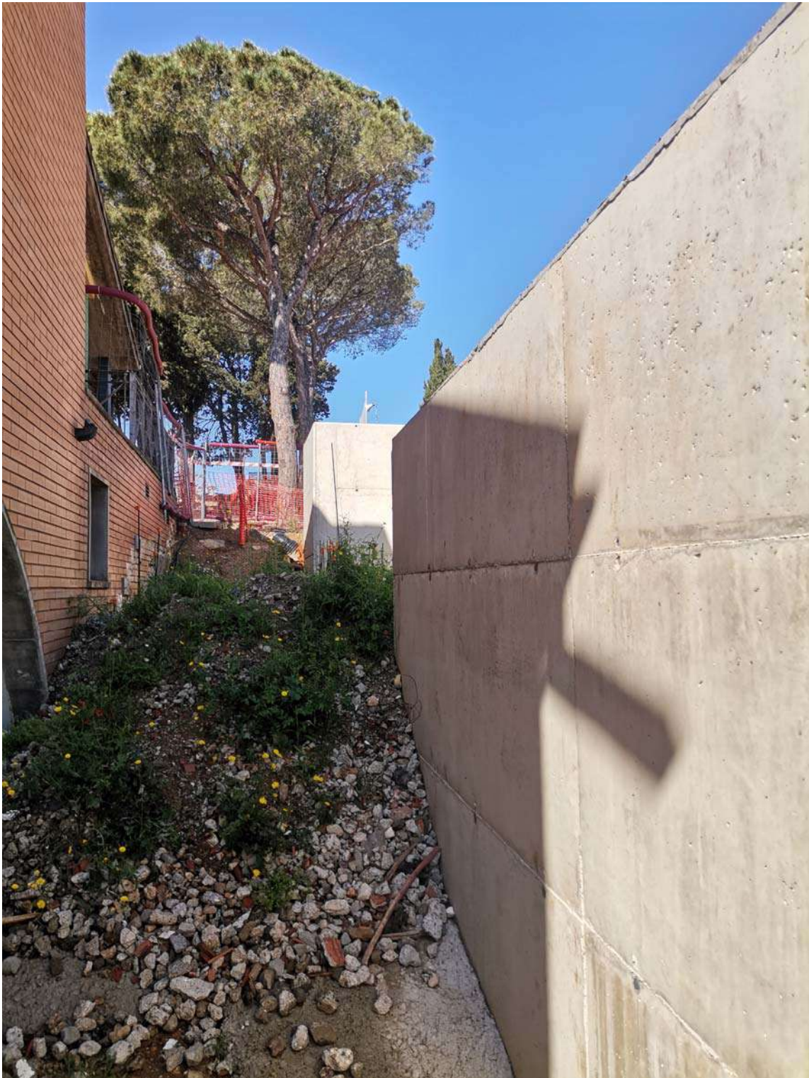
Estat actual de la construcció del mur M2 (li falta reparar la seva planeïtat)
