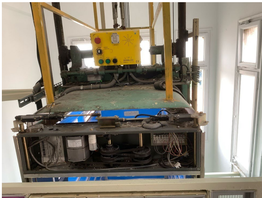
Detall de l'adaptació de l'operador de portes automàtiques de cabina
