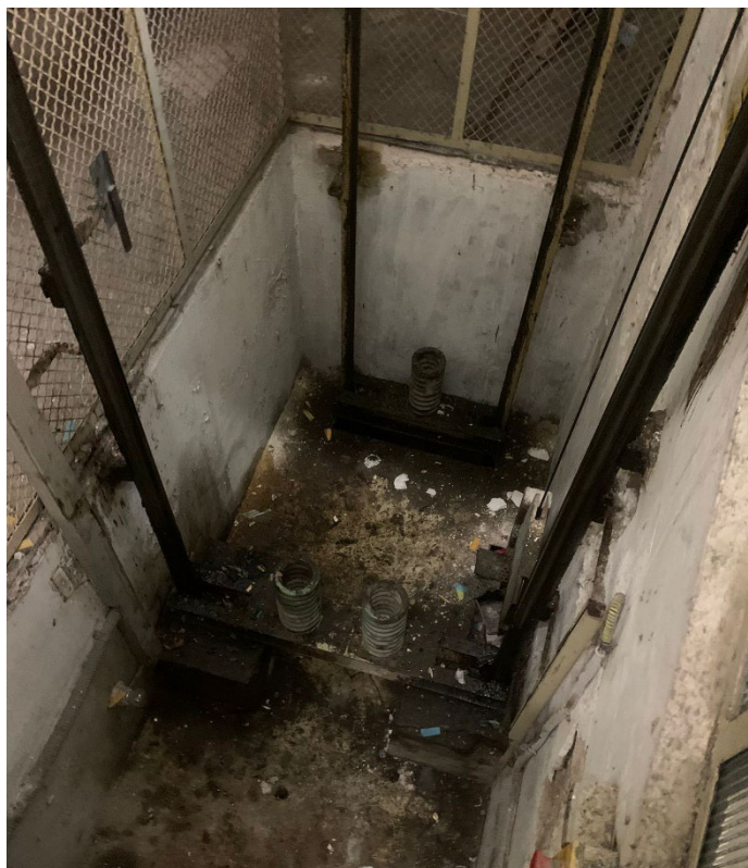
Vista del fossat dels ascensors 8283-B i 8284-B.
