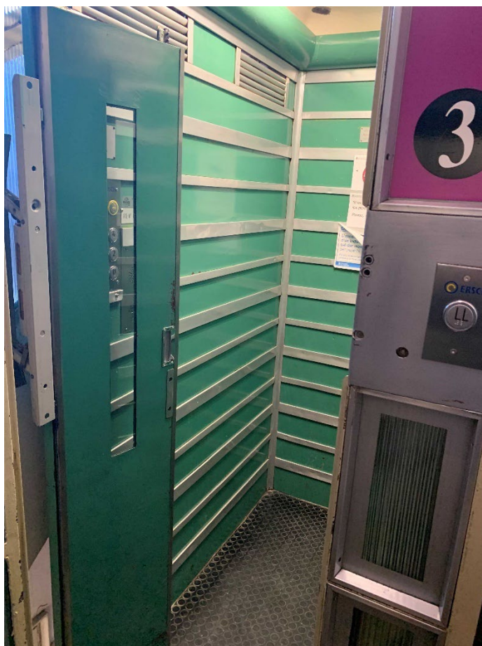
Vista frontal de replà i la cabina.
