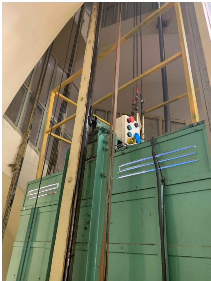
Vista detall del buc i de la cabina.
