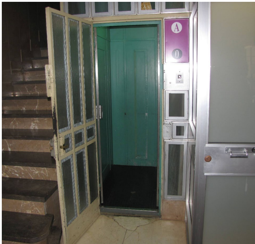
Vista frontal de l'ascensor i la cabina.
