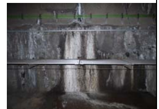
Filtració amb precipitat a lateral
