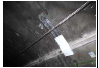
Filtració tapada a sostre
