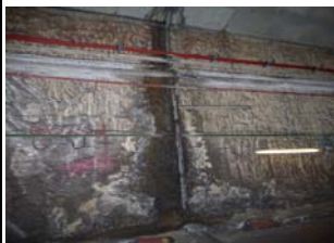
Filtració a lateral per junta
