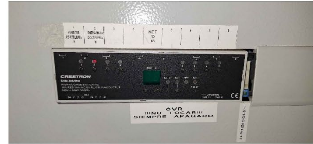
07_01. Substitució sistema Crestron.
