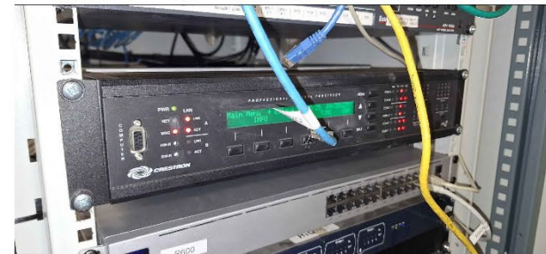
07_01. Substitució sistema Crestron.
