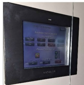
07_01. Substitució sistema Crestron.
