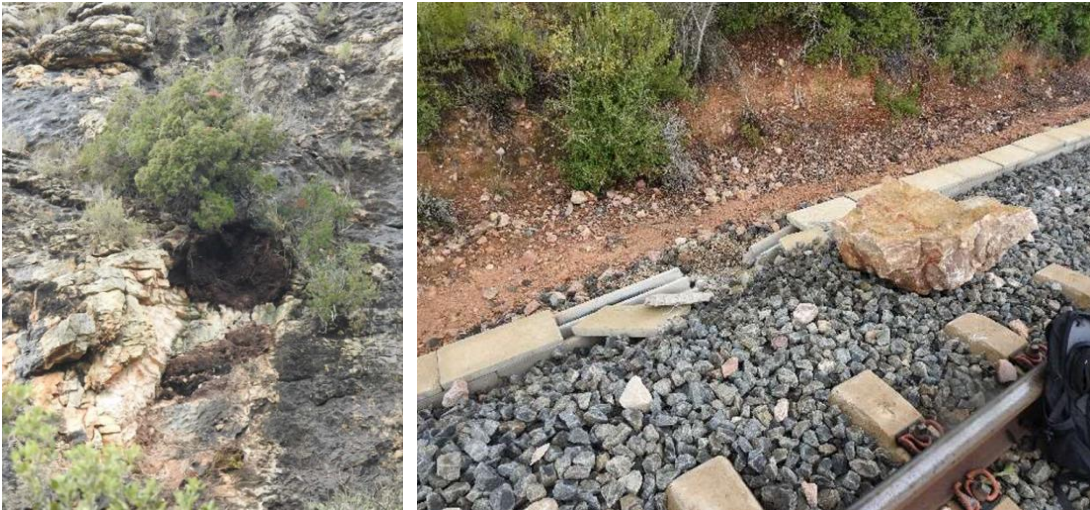
Figura 1. Despreniment de l'octubre de 2019. Zona de sortida i detall del bloc aturat a la zona de balast.
