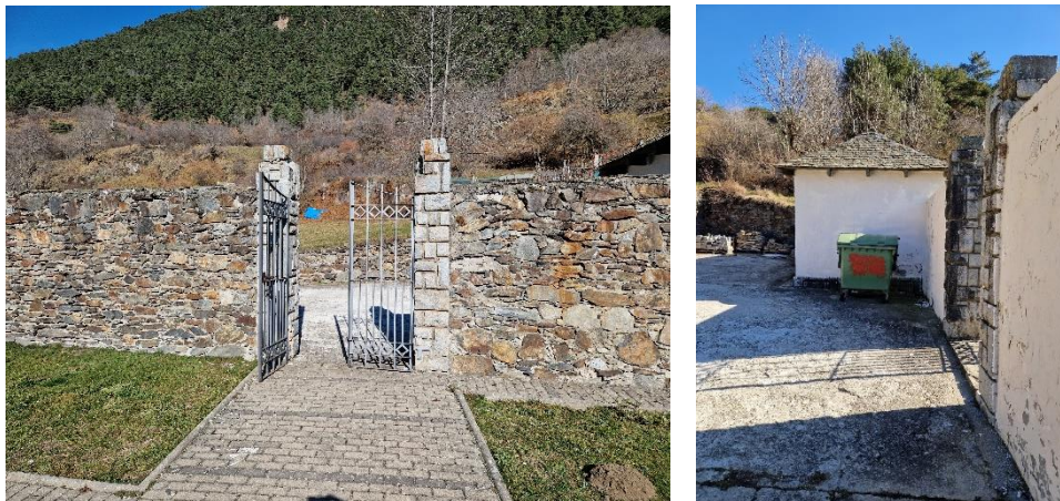
Imatge 7. Desperfectes puntuals. Murs a condicionar i porta d'accés.
