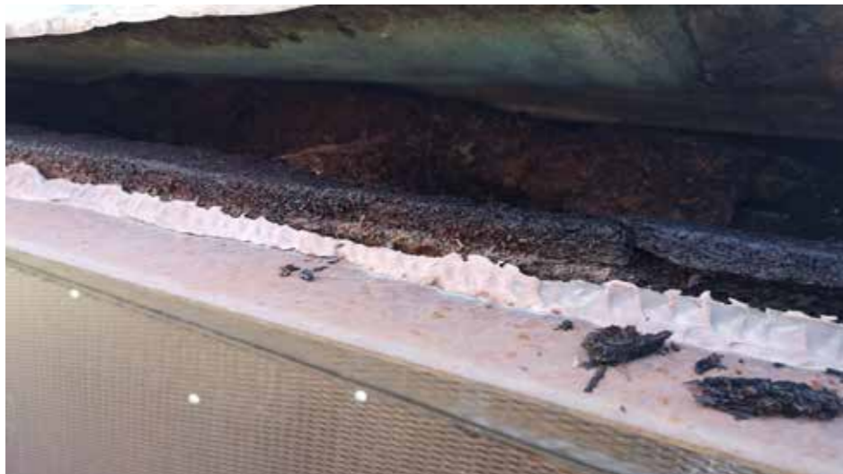
DESPERFECTES EN TAULER HIDRÒFUG
