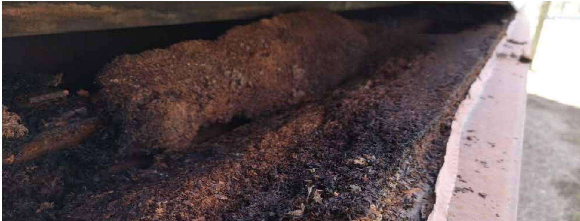
DESPERFECTES EN TAULER HIDRÒFUG
