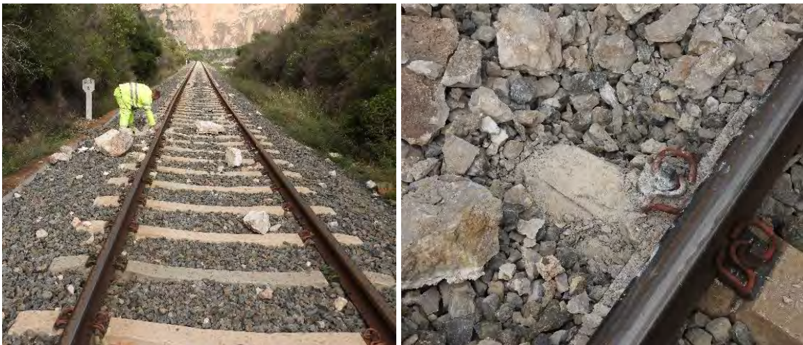
Figura 6. Detall dels blocs despresos i danys en una de les travesses.
