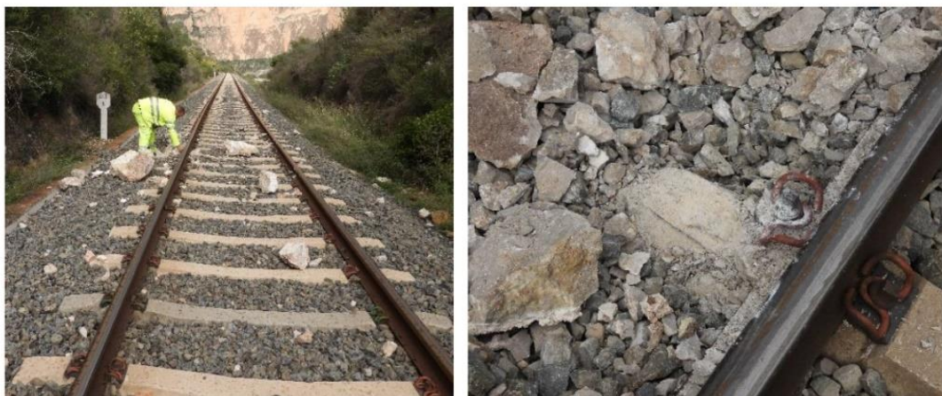
Figura 2. Detall dels blocs despresos i danys en una de les travesses.
