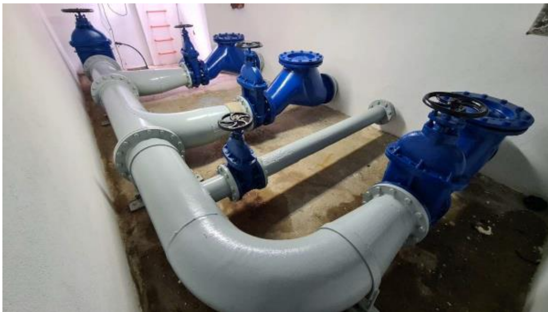
Figura 2. Vista de la caldereria i valvuleria de l'EBAR (sala adjacent al pou).
