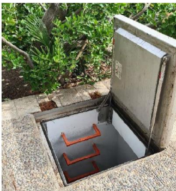
Figura 5. Vista de l'accés a l'EBAR La Illeta.
