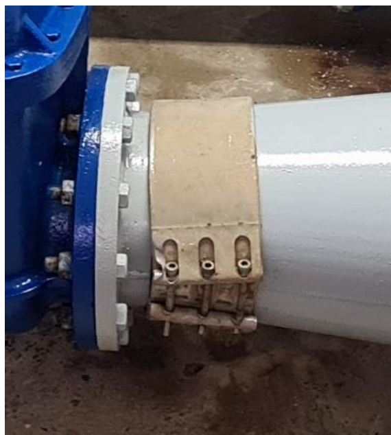
Figures 3, 4 i 5. Porus i reparacions ja efectuades degut al mal estat de la caldereria.
