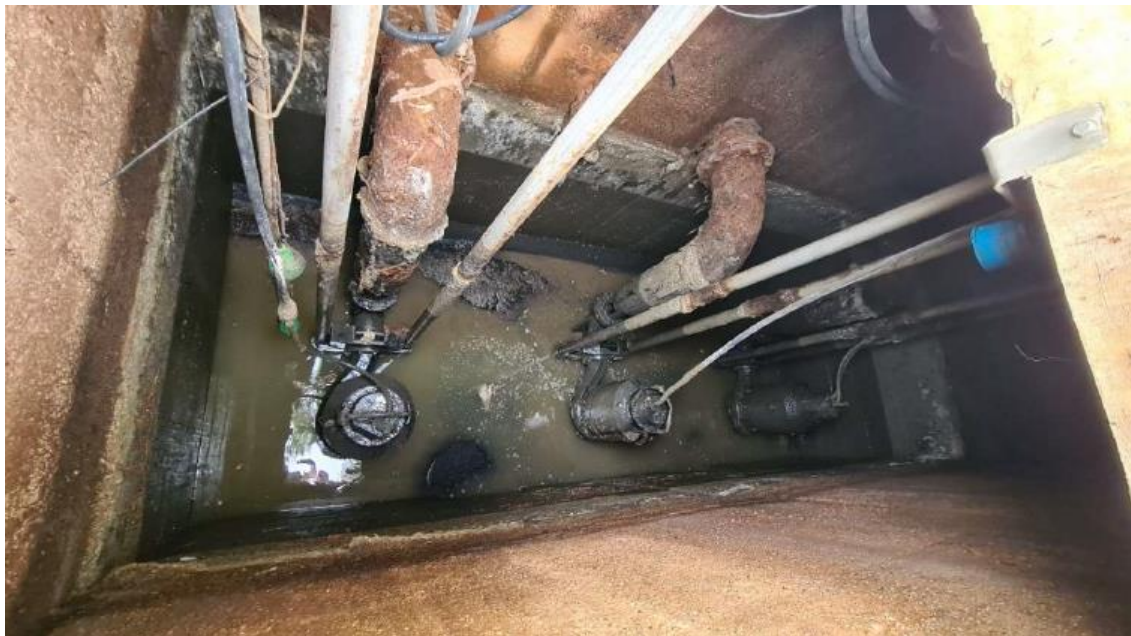
Figura 1. Pou de les bombes de l'EBAR La Illeta.
