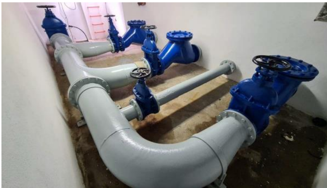
Figura 2. Vista de la caldereria i valvuleria existent.
