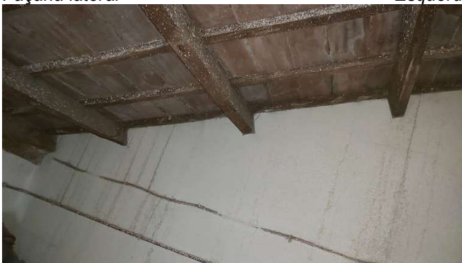
Entrada aigua fissura façana amb coberta
