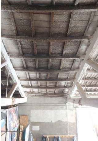
Corretges afectades Zona1
