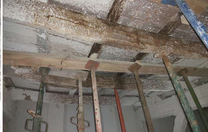
Corretges afectades Zona2
