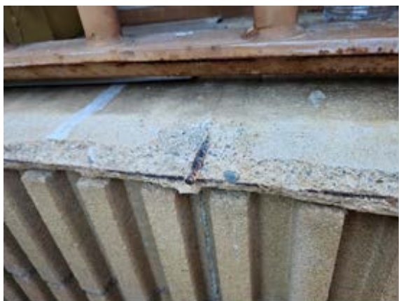
Varetes oxidades exposades
