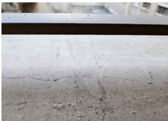
Fissures al formigó prefabricat
