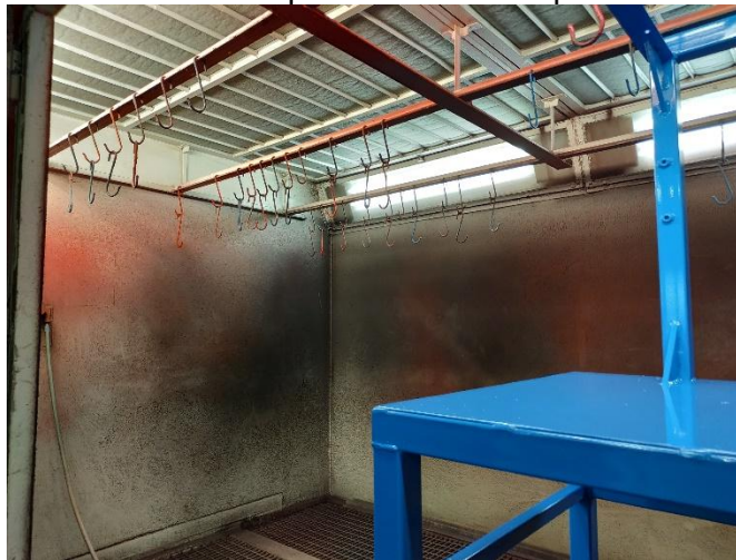
Figura 3 Interior de la cabina de pintura lagos
