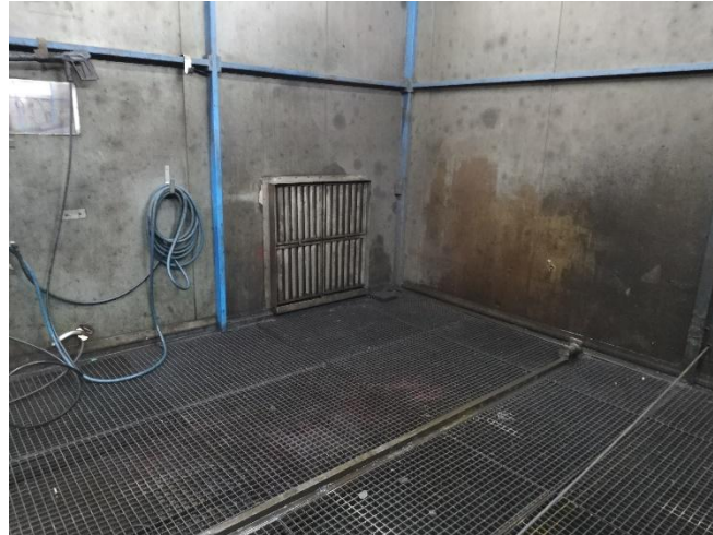
Figura 2 Interior de la cabina de rentat
