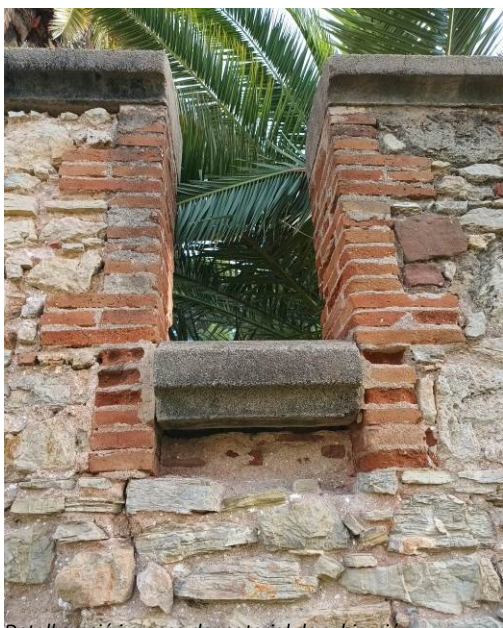
Detall erosió i manca de material de subjecció
