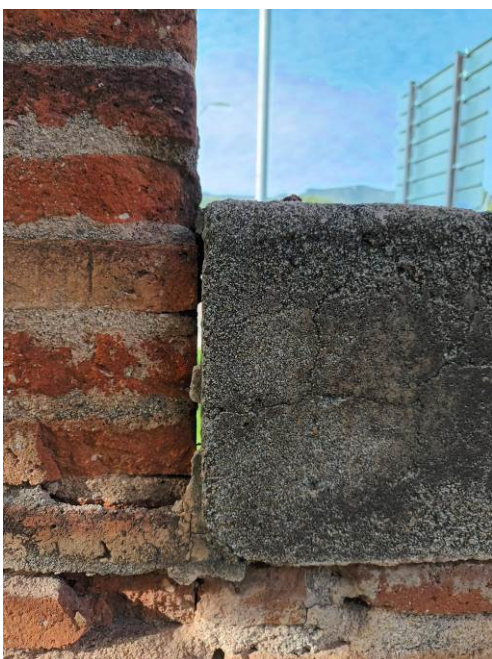
Detall erosió i manca de material de subjecció
