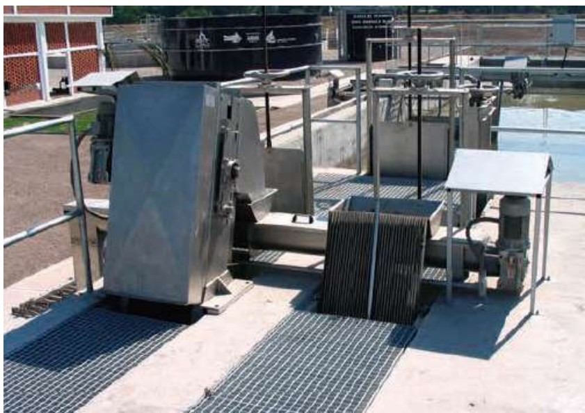
Reixa TITAN a cadena, instal·lada al col·lector d'entrada d'una EDAR
