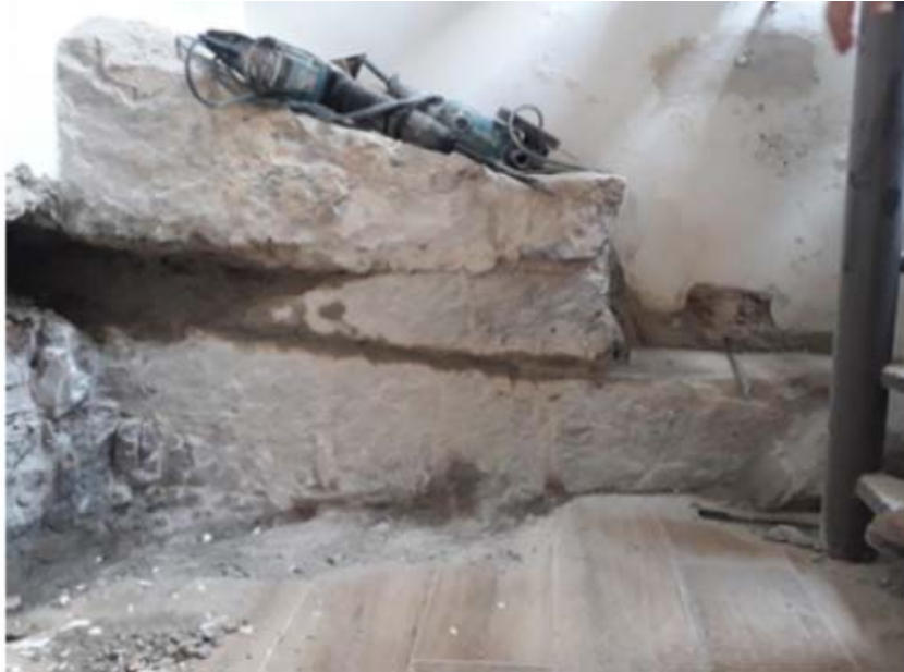
Fotografia extreta de acta d'inspecció de l'Ajuntament. Roca situada en la base del mur central, mur perpendicular a la façana anterior, situat en la vertical de la pilastra central de la façana principal. S'observa, per una banda, el tall i rebaix executat en la roca, i per l'altra les eines provablement utilitzades per executar el rebaix entre les que destacar el martell pneumàtic.
