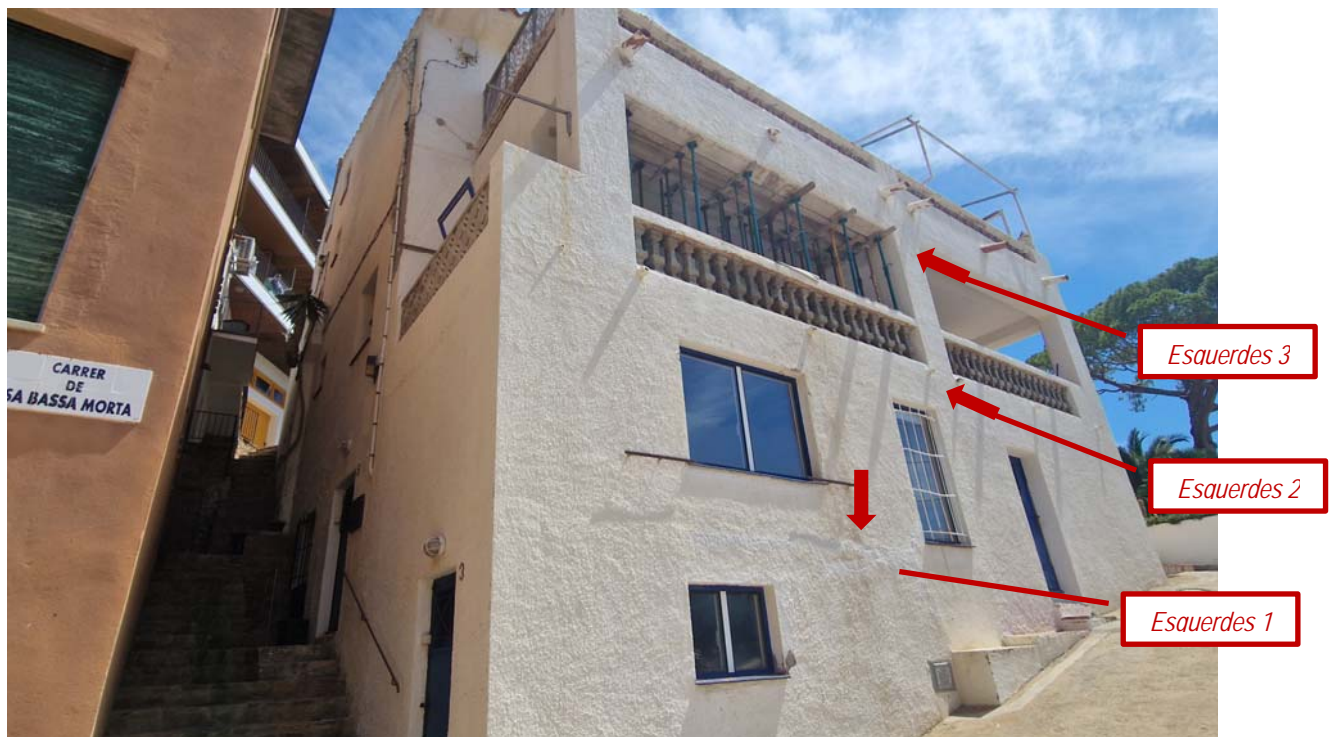
Façana sud i principal de l'edifici. Lesió 1, esquerdes en façana principal.
