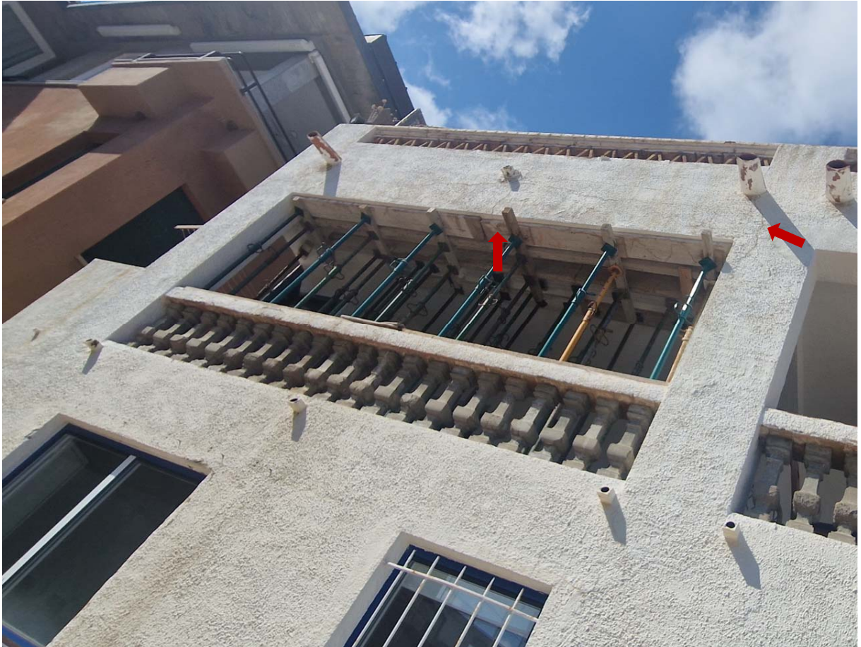
Façana sud, façana principal. Pòrtic situat al nivell 2, jàssera situada al sostre d'aquest nivell.
