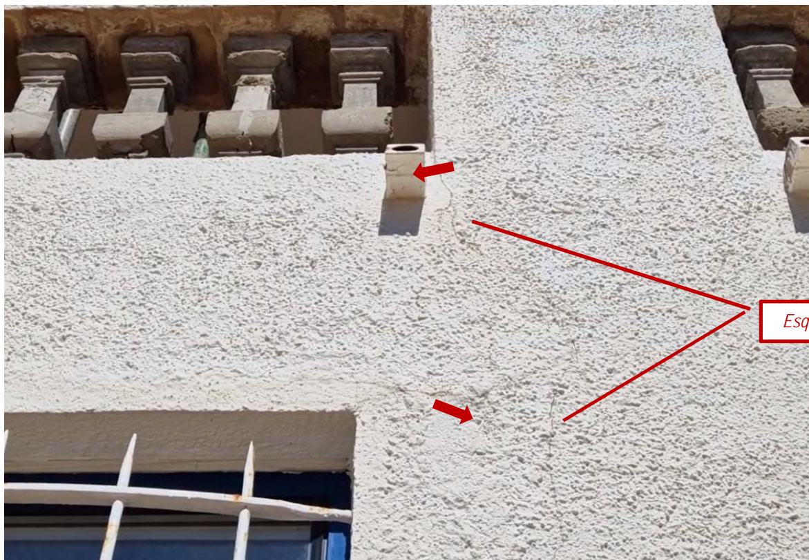
Façana sud i principal de l'edifici. Lesió 1, esquerdes en façana principal.
