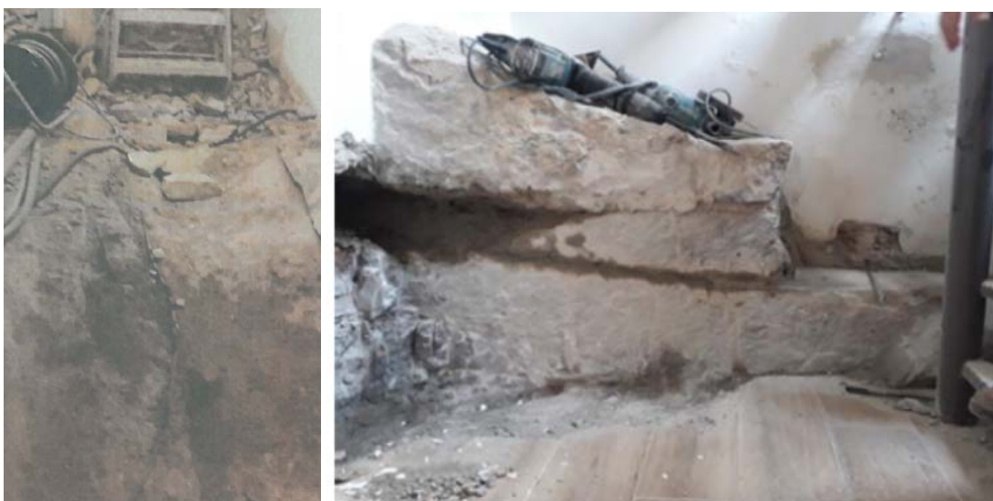
Nivell 1 de l'edifici (esquerra) i Nivell 0 de l'edifici (dreta), interior habitatge C/Escapes del port 3-5. Fotografies extretes de l'acta d'inspecció de l'Ajuntament. Roca situada en la base del mur central, mur perpendicular a la façana anterior, situat en la vertical de la pilastra central de la façana principal.
