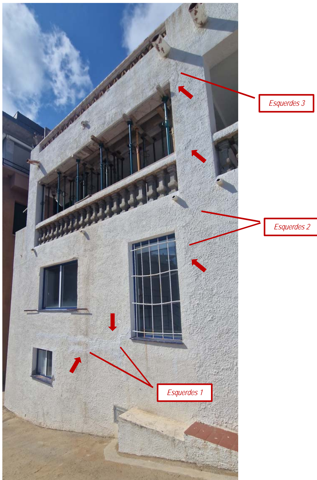
Façana sud i principal de l'edifici. Lesió 1, esquerdes en façana principal.
