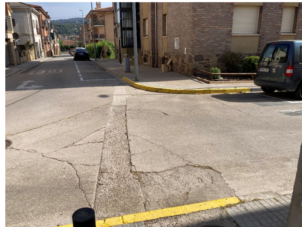
Figura 22. Estat actual carrer Tagamanent
