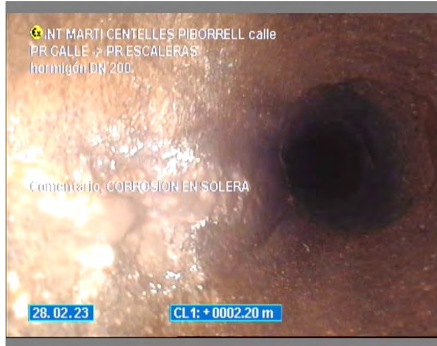
Foto: 1_2A, Medio N°: 280223_1, 00:00:50 2,2m, Comentario / CORROSION EN SOLERA
