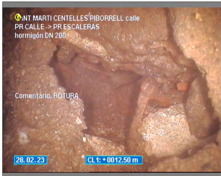
Foto: 1_5A, Medio N°: 280223_1, 00:05:21 12,5m, Comentario / ROTURA
