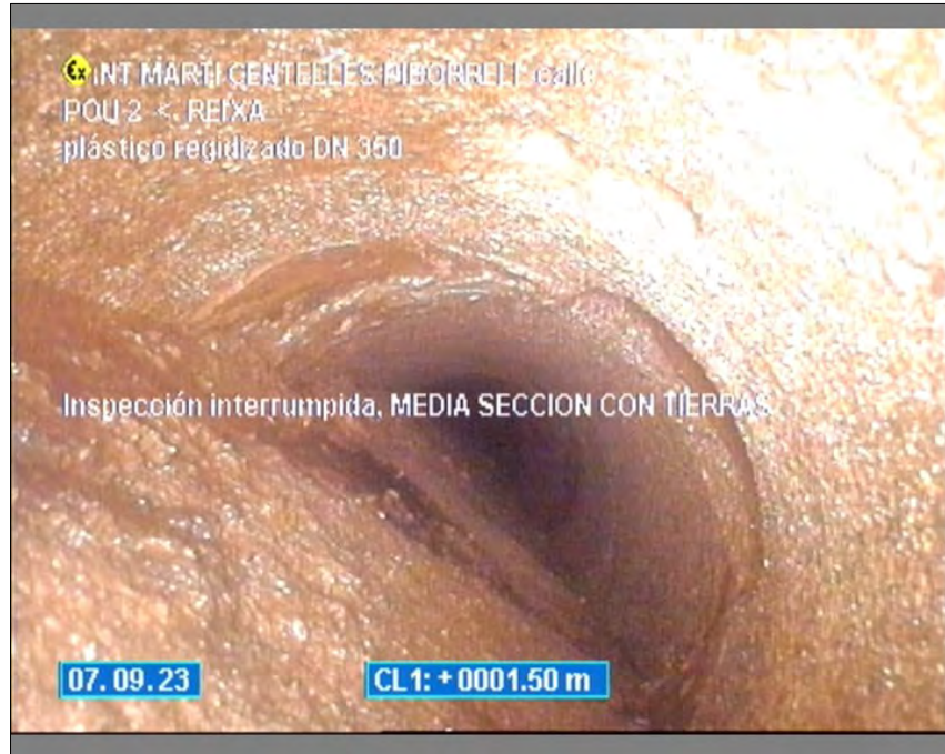
Foto: 2_2A, Medio N°: 070923_1, 00:00:32 1,5m, Inspección interrumpida / MEDIA SECCION CON TIERRAS
