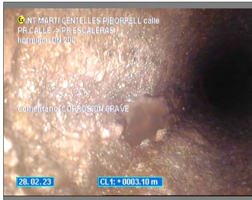
Foto: 1_3A, Medio N°: 280223_1, 00:01:38 3,1m, Comentario / CORROSION GRAVE
