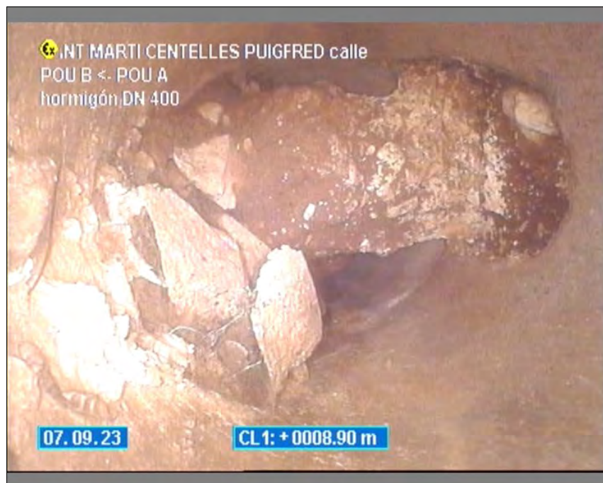
Foto: 6_2B, Medio N°: 070923_1, 00:01:08 8,9m, Inspección interrumpida / POR ACUMULACION DE SOLIDOS
