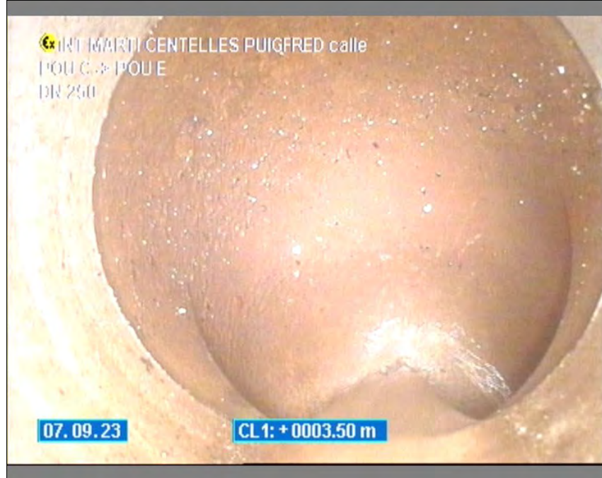
Foto: 3_2A, Medio N°: 070923_1, 00:01:03 3,5m, Inspección interrumpida / POR CODO DE CAIDA
