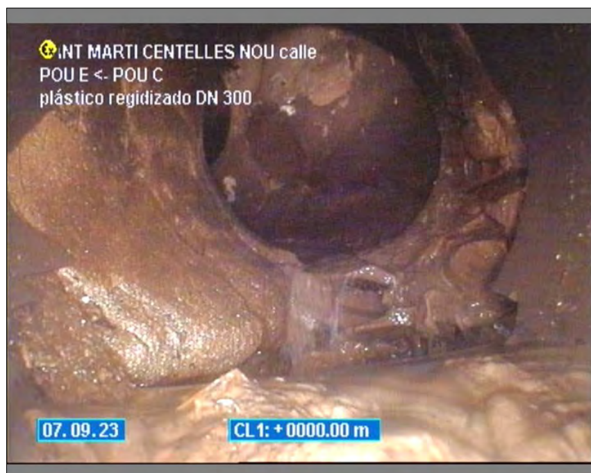
Foto: 12_2B, Medio N°: 070923_1, 00:03:16 9m, Inspección interrumpida / TUBO DE PVC ROTO EN ARQUETA OCULTA
