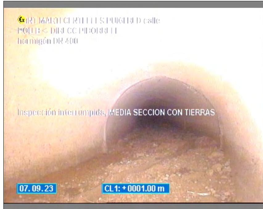
Foto: 7_2A, Medio N°: 070923_1, 00:00:27 1m, Inspección interrumpida / MEDIA SECCION CON TIERRAS
