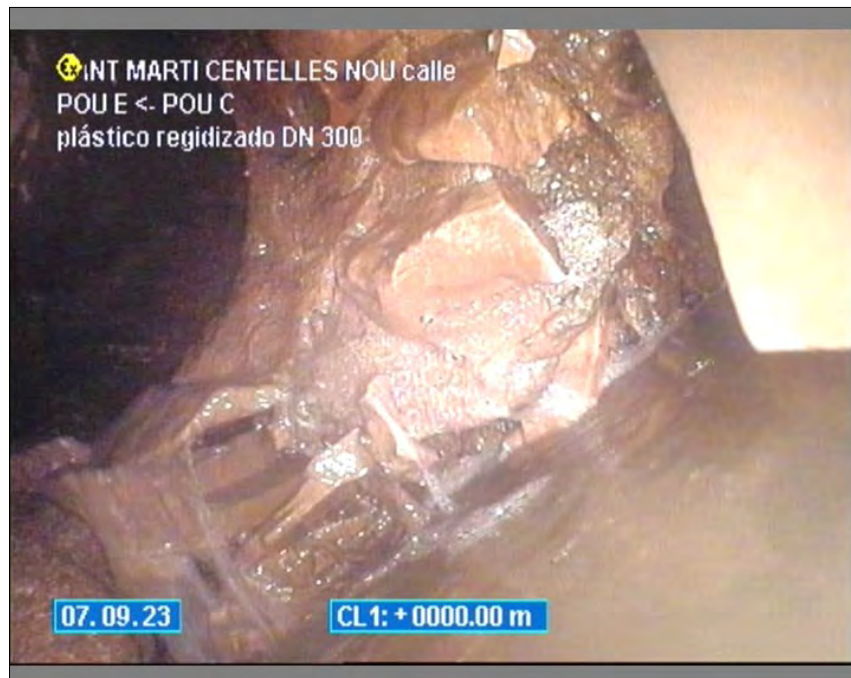
Foto: 12_2A, Medio N°: 070923_1, 00:03:16 9m, Inspección interrumpida / TUBO DE PVC ROTO EN ARQUETA OCULTA
