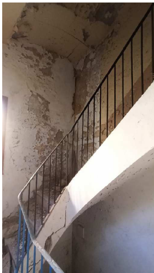
24 de desembre de 2024. Estat de l'escala amb filtracions i trencament de la volta.
