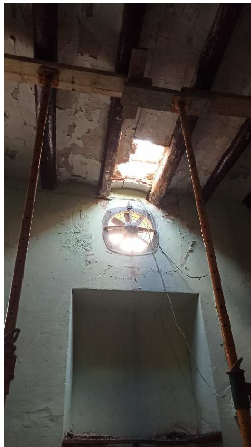
11 de febrer de 2025. Trencament del sostre de la planta primera per la caiguda de la coberta.
