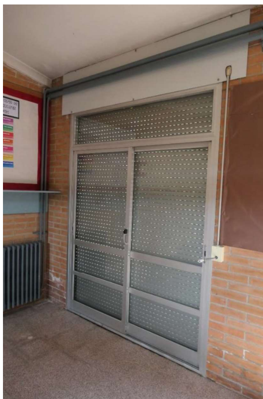
Portam existent en aules- A01
