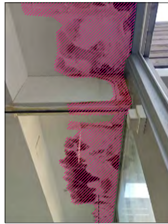
[C] humitats al fals sostre a la franja de façana sud
