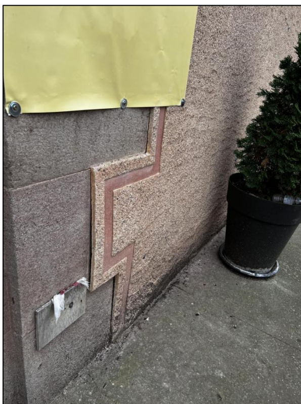
Fig.3 Detall d'un aixecament puntual del revestiment respecte al mur
