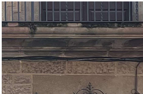
Despreniment de material.
