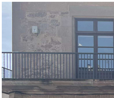
Despreniment de material.
