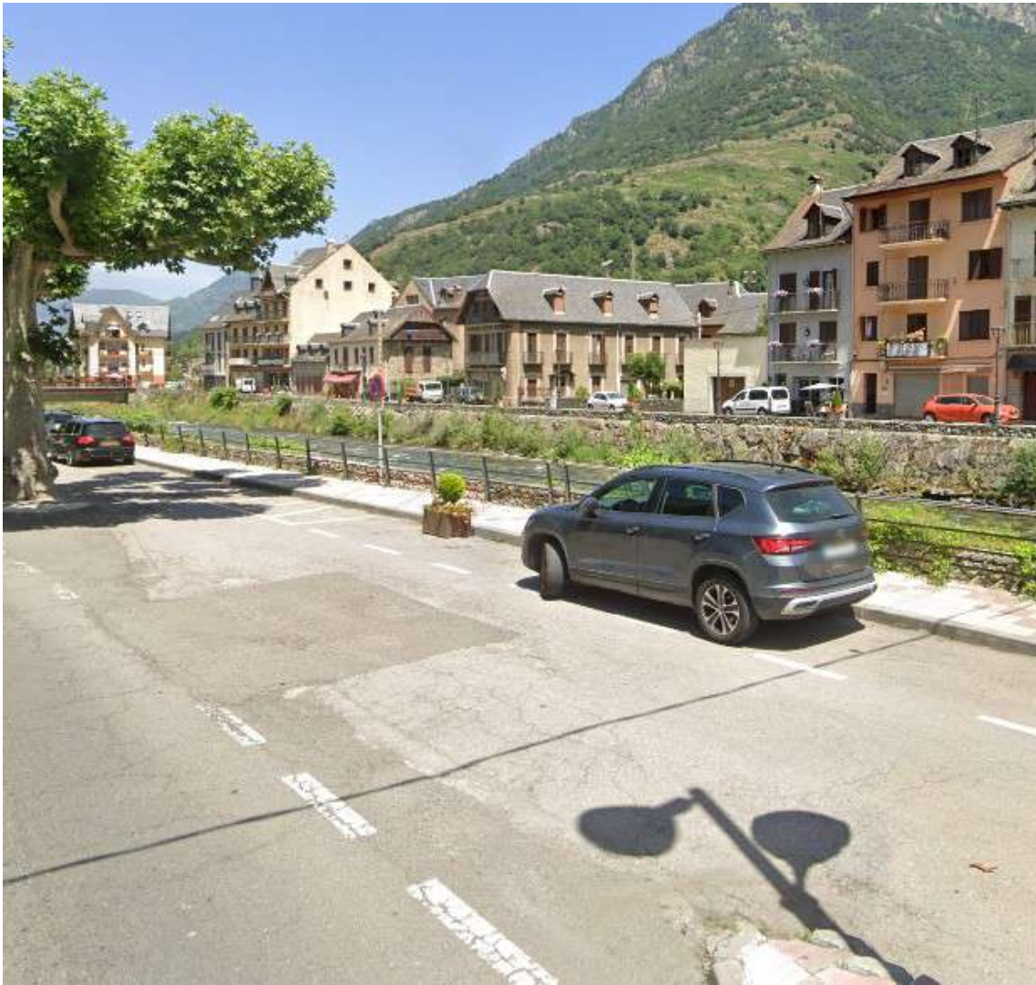
Imatge 4. Paviment lateral per circulació i aparcament en estat precari.
