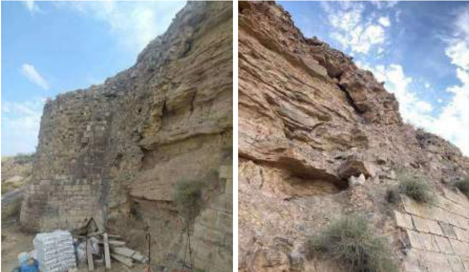
Tram de mur de muralla esfondrat
