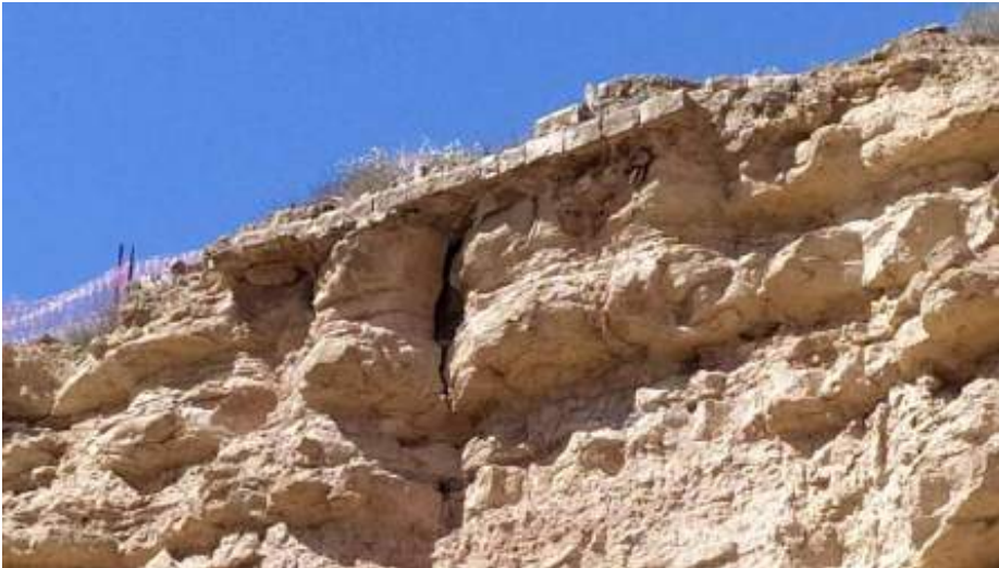
Restes de mur de carreus en el vessant est, en situació aparentment inestable
