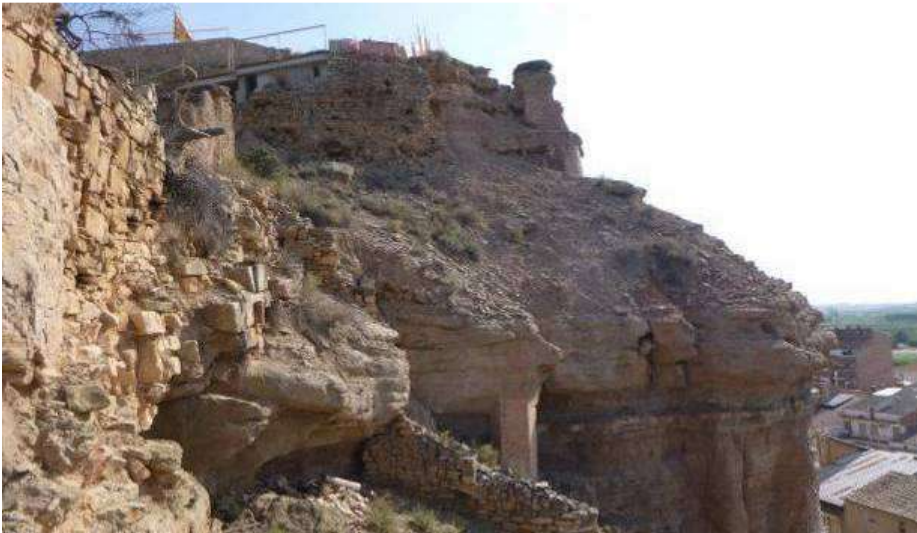
Vista de la torre sud erosionada en la seva base immediata i en els estrats inferiors
