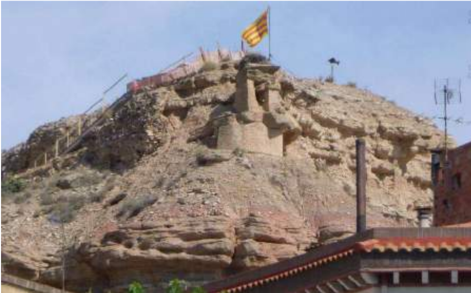
Vista de la torre sud erosionada en la seva base i suportada amb murs d'obra de fàbrica de maó
