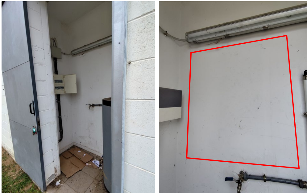
Figura 4 Sala per ubicació de l'inversor i els quadres de proteccions
