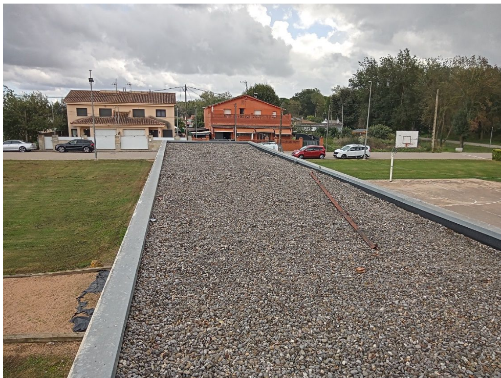
Vista parcial de la coberta, S'observen les graves d'acabat de la coberta plana invertida.
