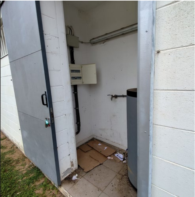
Sala tècnica existent
