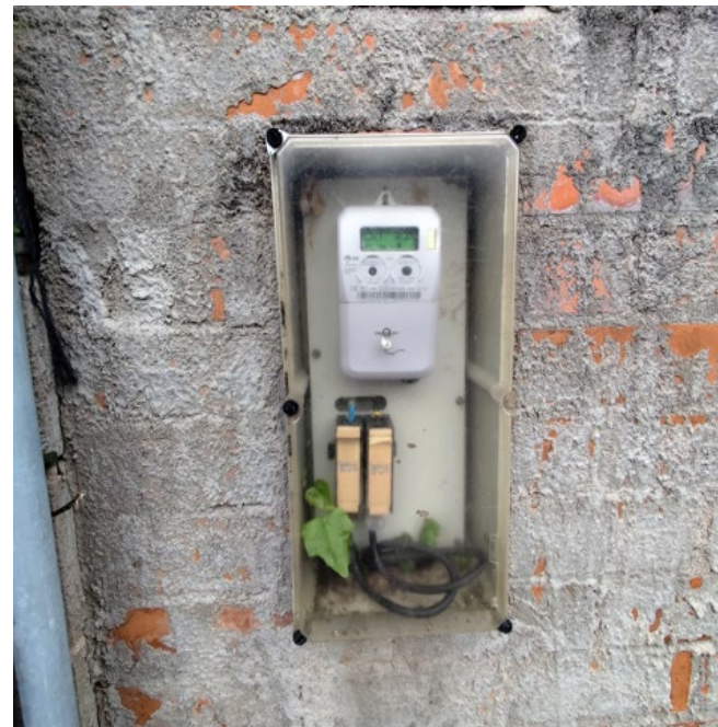
Escomesa elèctrica (CPM-MF2)
