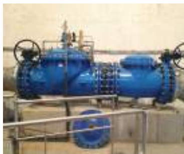
CAJA DE FILTROS PROTEGIENDO UNA VÁLVULA HYDROBLOC
