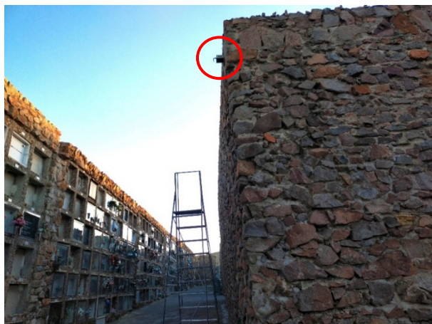
Vista posterior del Bloc 14 – Clinòmetre 14B
