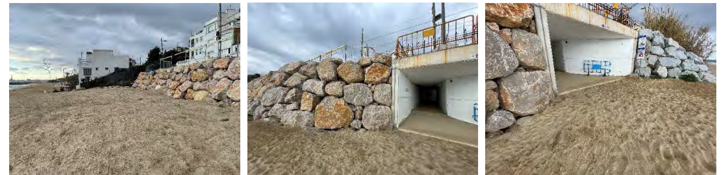
Imatges del mur límit del passeig marítim executat durant les obres d'emergència i el calaix sota vies.
