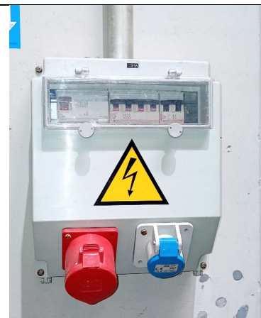
5 subquadres elèctrics distribució
