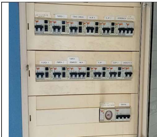
1 Quadre Secundari de Distribució i climatització
